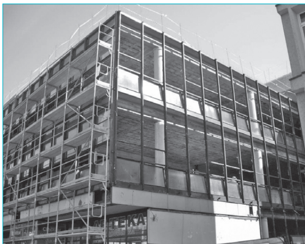
8. Dom towarowy w trakcie przebudowy, lipiec 2010 r. – rozebrano charakterystyczne, kubiczne elementy na dachu; likwidacja oryginalnej stolarki i szklenia. Fot. autorka
