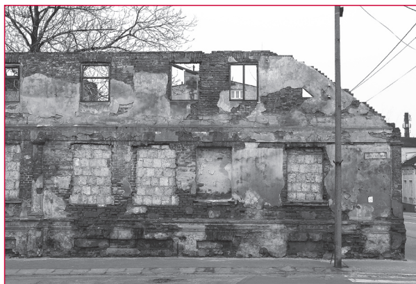
8. Budynek d. plebanii ewangelicko-augsburskiej w Zgierzu – elewacja od strony ul. Narutowicza, stan z 2011 roku. Fot. P. Filipowicz, W. Witkowski, archiwum OT NID w Łodzi
