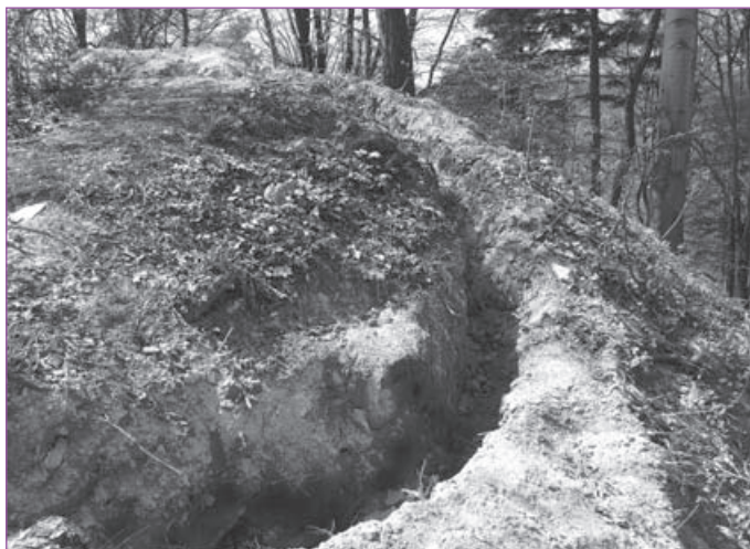
1. Krajowice. Relikty zamku Goleisz. Przykład dewastacji nawarstwień archeologicznych – wykop odsłaniający podziemną partię murów zamku, kwiecień 2009. Fot. I. Malawska.
