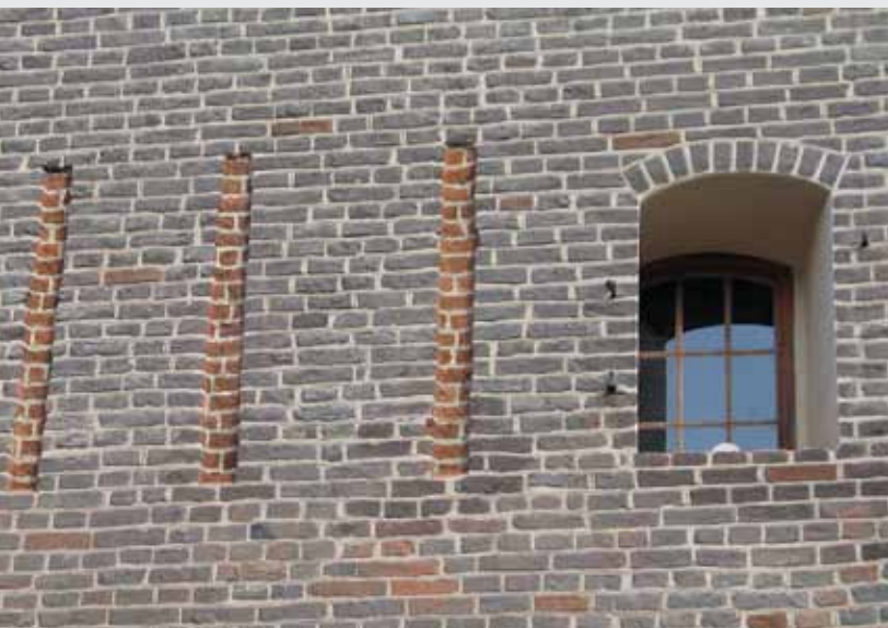
Fot. 2. Frombork, wieża wodna, fragment ceglanej elewacji po pracach konserwatorskich (fot. archiwum konkursu „Zabytek Zadbane”).
