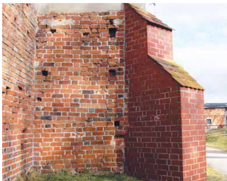
Fot. 6. Metrowej grubości ściany tego kościoła są w wielu miejscach poważnie spękane. Widoczna na zdjęciu szkarpa została przez „miejscowych” obłożona współczesnym klinkierem, najpewniej dla ukrycia złego stanu. W długiej historii kościoła prace wykonane tak przecież niedawno, wykonane w dobrej wierze, zburzyły integralność techniczną obiektu, przez co stały się niestety przyczyną przyspieszonej destrukcji oryginalnej materii (fot. B. J. Rouba).
