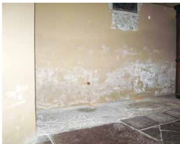
Fot. 12. Wygląd zabytku w rok (!) po wykonanych pracach pokazuje, że z fizyką się nie wygrywa. Nieuregulowane problemy wilgotnościowe, mur niedoprowadzony do równowagi po długotrwałym zawilgoceniu zachowuje się w sposób typowy – odrzuca nasze próby zakamuflowania prawdziwego stanu rzeczy (fot. B. J. Rouba).
