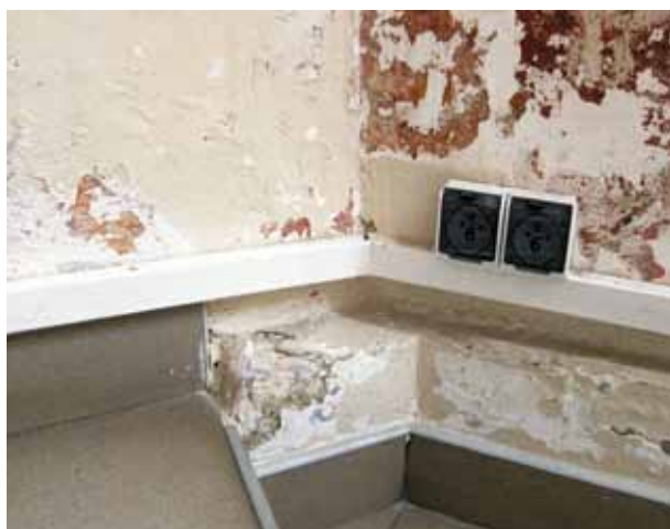
Fot. 11. Sytuację nierównowagi wilgotnościowej w tym samym kościele pogarsza dodatkowo gresowa posadzka, wykonana we współczesnej, szczelnej technologii. Powoduje ona „efekt knota”, przemieszczanie się wody z podłoża i odparowywanie przez mur. Na fotografii widać odpadające na skutek zawilgocenia warstwy wierzchnie, spod których przebiera wcześniejsza dekoracja malarska, również zresztą intensywnie niszczone przez wodę. Oprócz zniszczeń na fotografii widzimy rozwiązanie warte naśladowania – instalacje poprowadzone na powierzchni, bez kucia i kaleczenia zabytkowego muru. Jest taniej, szybciej, czystiej i mądrzej! (fot. B. J. Rouba).
