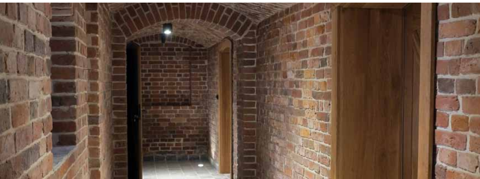
Dwór w Psieniu-Ostrowie – laureat kategorii adaptacji obiektów zabytkowych | Fot. B. Marzęta, NID OT Poznań
