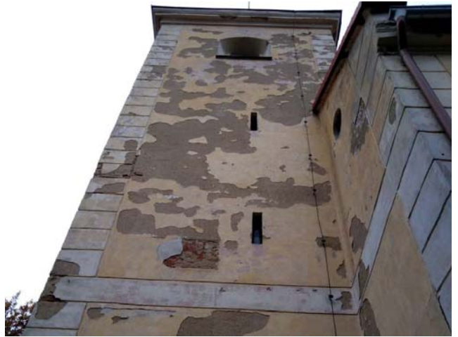
Fot. 3. Uszkodzenia i zacieki na tynku na południowej ścianie wieży
