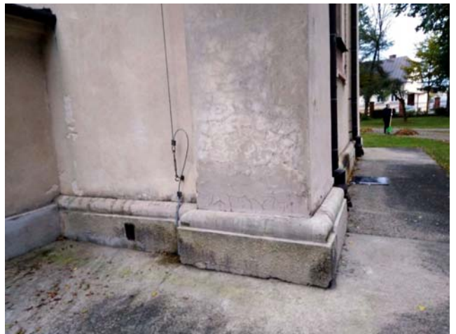
Fot. 5. Miejsce pomiaru 36a z uszkodzeniami na tynku, gdzie były wskazania zawilgocenia do 1,5 m od podłoża
