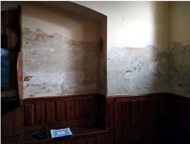
Fot. 2. Uszkodzenia tynku przy wejściu do klasztoru. Wg relacji księdza nastąpiła awaria rynny
