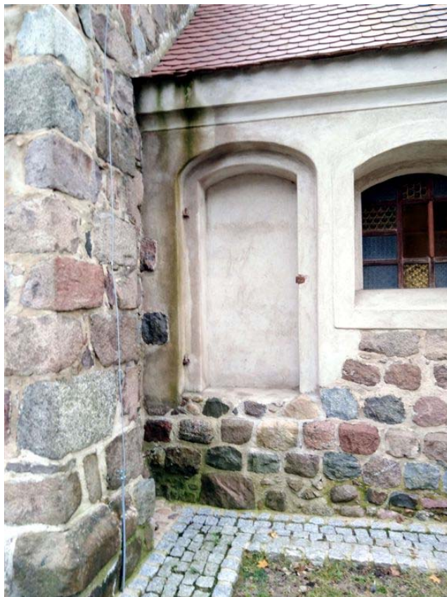
Fot. 3. Zacieki na murze są związane z uszkodzeniami dachówek na krawędzi dachu
