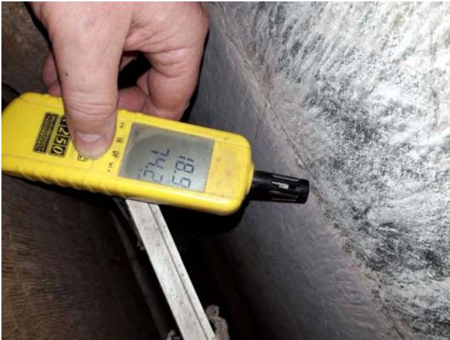
Fot. 19. Klimat sprzyjający kondensacji panuje pomiędzy oparciami ław a murem w kapitularku
