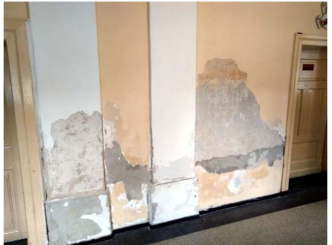
Fot. 3. Uszkodzenia tynku wewnątrz klasztoru. Tu nastąpiła awaria rury wodnej
