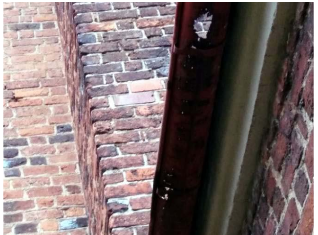
Fot. 6. Poważny stopień zużycia i nieszczelności rynien
