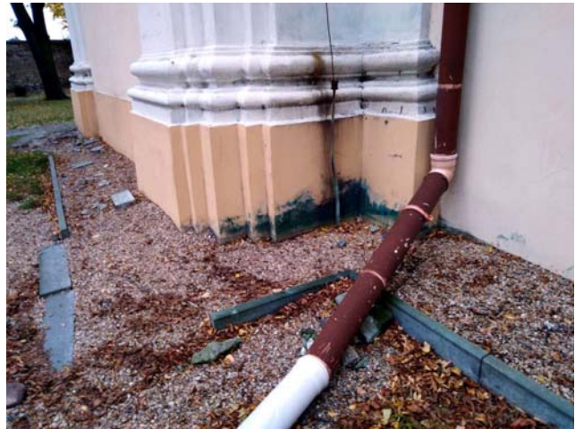
Fot. 7. Na południowej elewacji ślady zalewania z miedzianego dachu lub rynien. Widoczna też niewykończona opaska żwirowa. Pionowy ślad pochodzi od wody ściekającej z pionochronu
