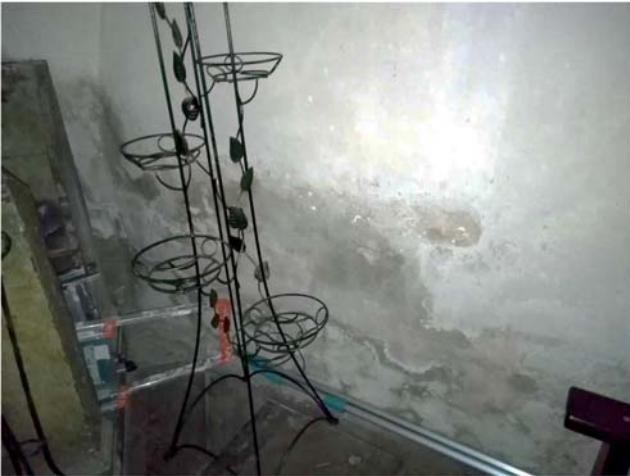
Fot. 2. Uszkodzenia powierzchni tynku za ołtarzem związane są ze wzrostem mykoorganizmów
