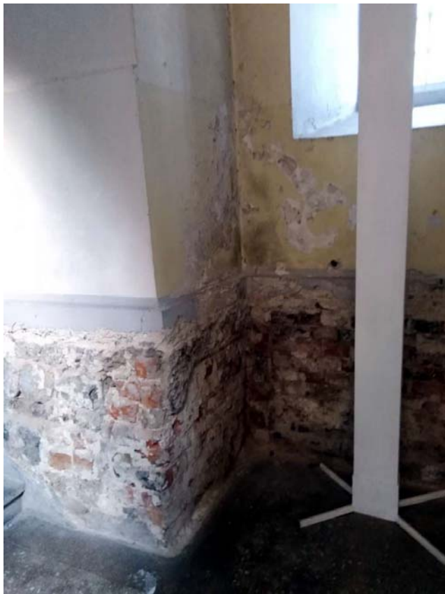
Fot. 2. Uszkodzenia tynku w północno-zachodnim narożniku nawy
