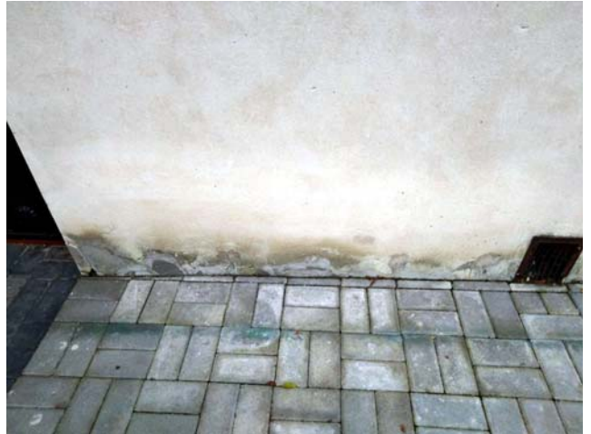
Fot. 3. Widoczna na ścianie plama od rozpryskiwania się wody deszczowej na twardej powierzchni. Zielone ślady na bruku wskazują na wady miedzianych rynien
