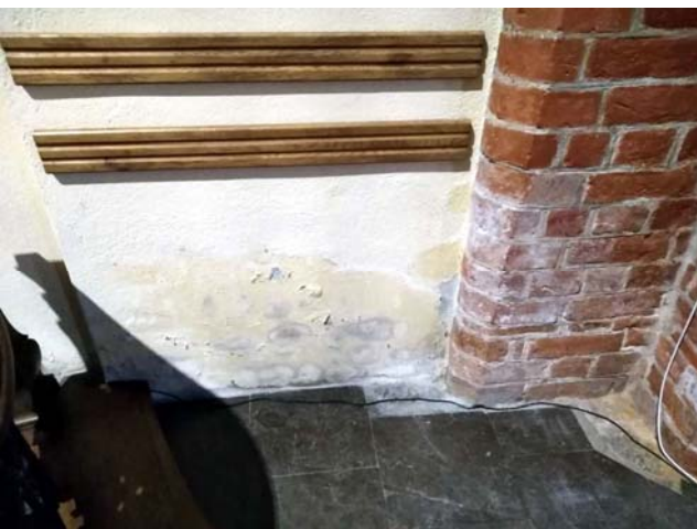
Fot. 6. Wysolenia na ceglach pilastra i tynku na południowej ścianie wewnątrz prezbiterium
