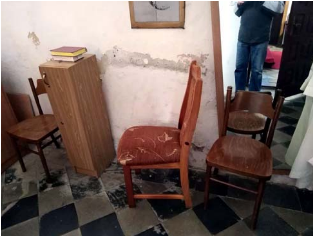
Fot. 2. Uszkodzenia tynku w zakrystii
