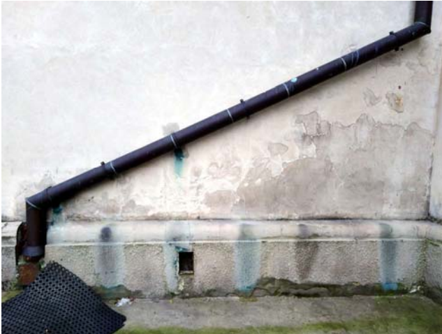
Fot. 2. Zacieki z rury spustowej. Jest to główna przyczyna zawilgocenia miejsca nr 26
