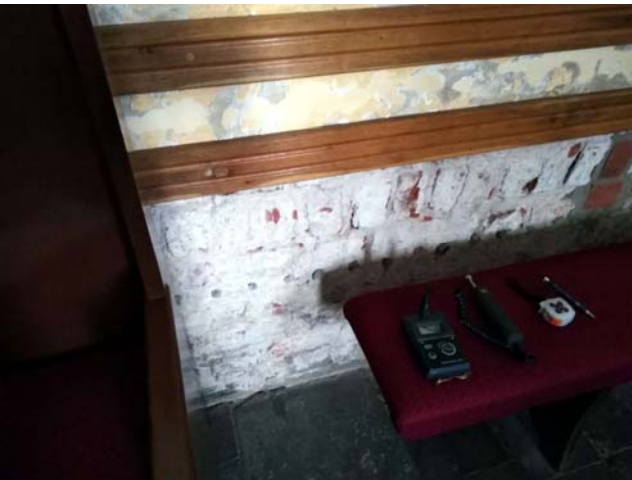
Fot. 4. Na ścianach nawy tynk usunięty od czasu wykonania iniekcji do wysokości 65 cm od posadzki, wyżej widoczne liczne objawy wysoleń
