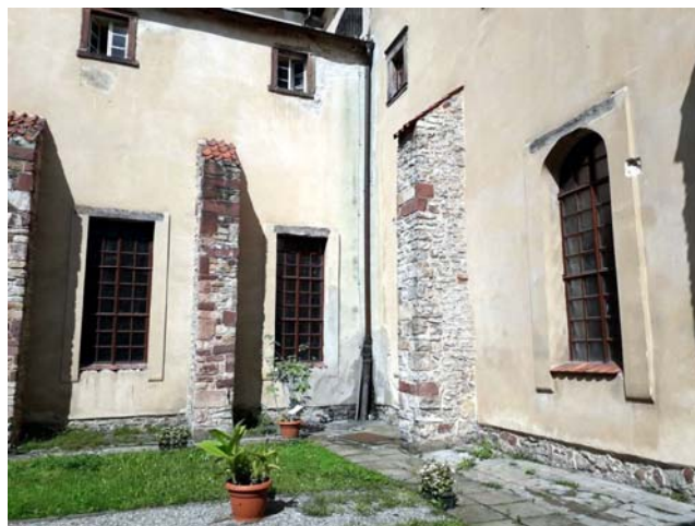
Fot. 8. Wirydarz. Zacieki wzdłuż rury spustowej. Miejsce nr 88
