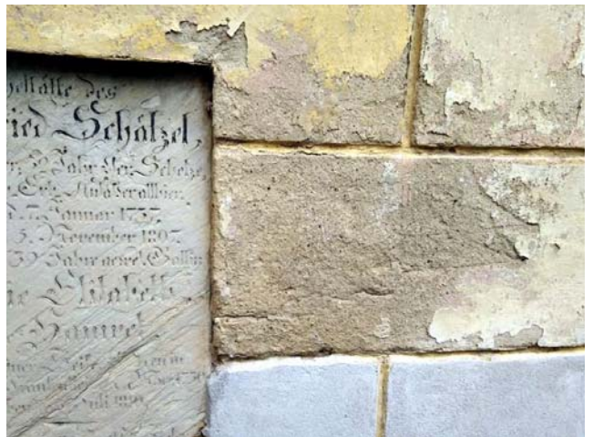
Fot. 5. Uszkodzenia tynku na elewacji - prawdopodobnie z powodu zasolenia - miejsce pomiaru 34
