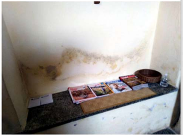
Fot. 5. Mykoorganizmy na ścianie w kruchcie.
