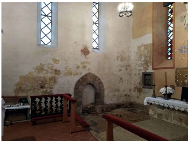
Fot. 4. Bardzo wyraźna plama na tynku jest na północnej i częściowo na wschodniej ścianie prezbiterium, plama ma zakres pokrywający się z dawną zakrystią
