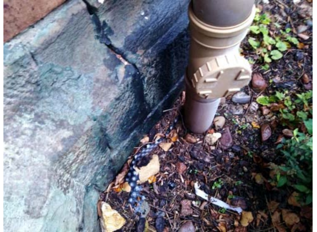
Fot. 4. Widoczna folia kubełkowa wystająca przy murze. Na kamiennym cokole ślady zaciekania wody z miedzianego dachu
