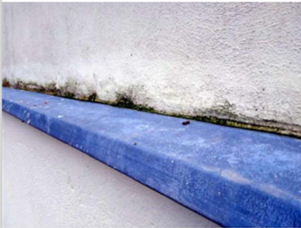
Fot. 6. Glony rosnące na ścianie wzdłuż obróbki blacharskiej.
