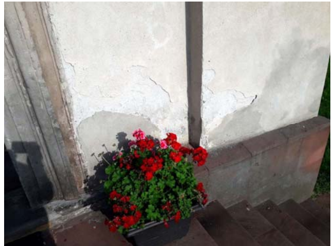
Fot. 13. Ślady rozprysku wody przy schodach zewnętrznych wejścia do muzeum. Miejsce nr 189
