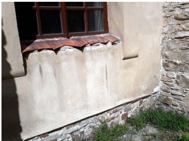
Fot. 7. Urwane parapety powodują zaciekanie wody
