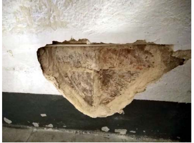
Fot. 3. Miejsce odspojenia tynku na południowej ścianie nawy ujawnia kamienne bloki muru
