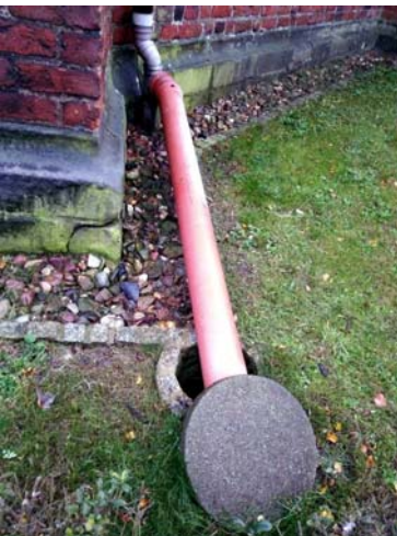
Fot. 5. Rura spustowa, z powodu niedrożności podziemnego odprowadzenia, została odprowadzona do dalszej od muru studzienki, która wg relacji osób związanych z kościołem również jest niedrożna i woda opadowa wylewa się na trawnik
