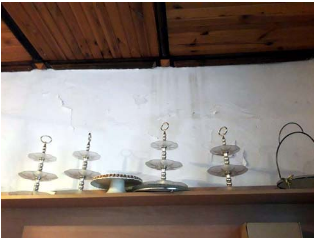
Fot. 14. Zacieki pod stropem w bufecie są, wg relacji, śladami po zalaniu
