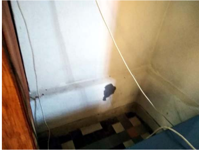
Fot. 2. Niewielkie uszkodzenie na tynku przy wejściu do kaplicy północnej
