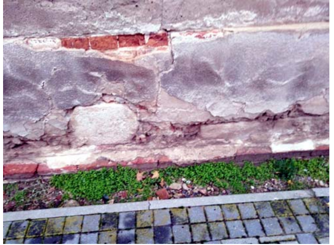
Fot. 3. Resztki cementowo-wapiennego tynku na cokole
