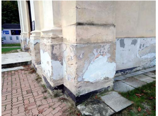
Fot. 3. Uszkodzenia tynku w strefie cokołu
