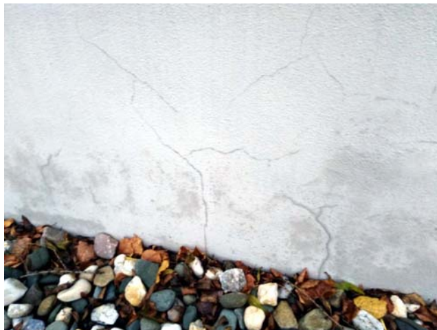
Fot. 3. W niektórych miejscach cokołu widoczne są spękania wyprawy tynkarskiej
