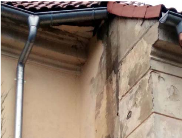
Fot. 4. Uszkodzenia i zacieki na tynku pod gzymsem dachowym nad miejscem pomiaru 47
