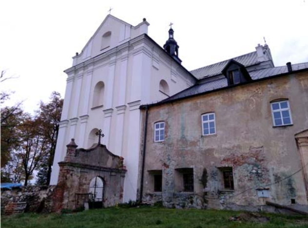
Fot. 4. Widok na odnowioną ścianę prezbiterium oraz nieodnowioną zakrystię. Zielone zacieki na elewacji to skutki wad technicznych rynien
