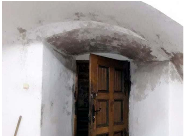
Fot. 20. Efekty kondensacji na nadprożu wyjścia z kuchni na klatkę schodową
