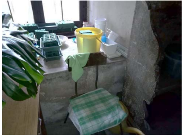
Fot. 3. Uszkodzenia tynku na wschodniej ścianie prezbiterium, pod oknem, za ołtarzem (punkt pomiarowy nr 3)
