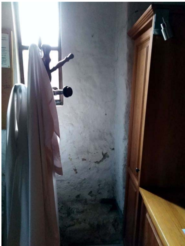
Fot. 2. Uszkodzenia tynku w nowej zakrystii
