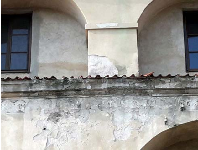
Fot. 12. Zalewanie i rozprysk wody deszczowej widoczny nad południowym wejściem do klasztoru. Miejsce nr 180
