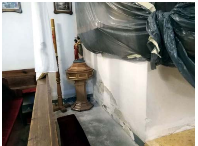
Fot. 7. Uszkodzenia tynku w dolnej strefie ściany nawy (miejsce pomiaru 13)
