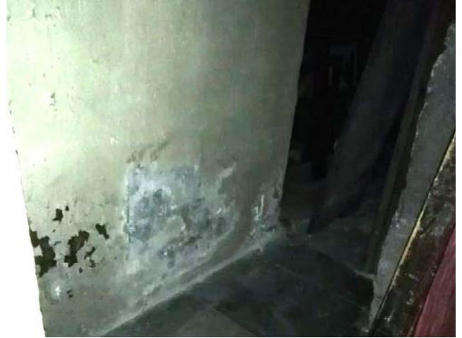
Fot. 3. Uszkodzenia tynku za ołtarzem, w prezbiterium
