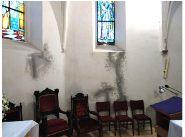
Fot. 5. Naprawy spękań muru. Problem pęknięć występuje w kościele od dawna, wymieniany był w projekcie z 2007r.
