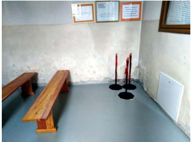
Fot. 3. Uszkodzenia powierzchni ścian w kruchcie
