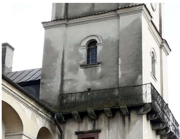
Fot. 10. Ślady zalewania wodą deszczową na wieży. Miejsce nr 195
