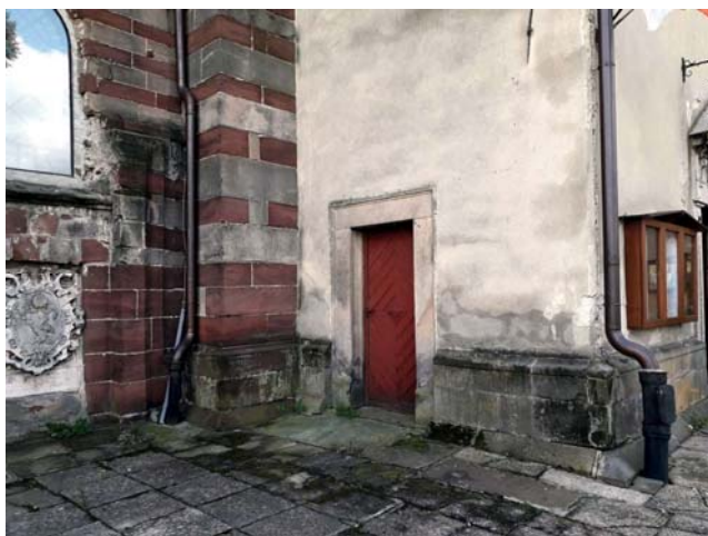
Fot. 4. Uszkodzenia związane z wilgocią rozpryskową nad cokół przy wejściu do kościoła. Miejsce nr 201
