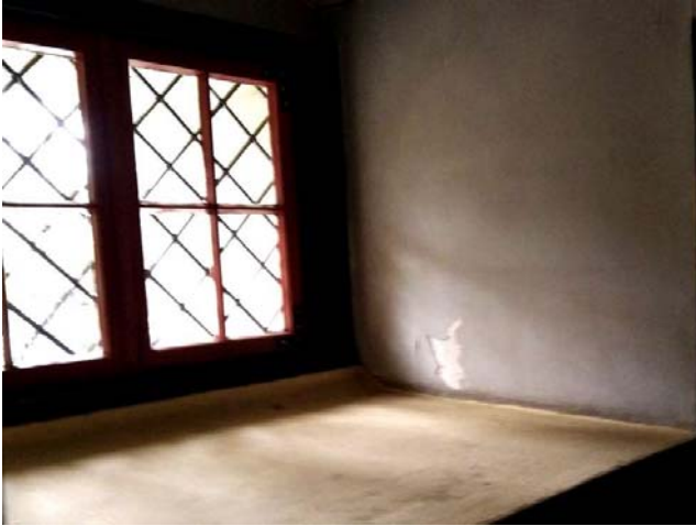
Fot. 2. Uszkodzenia wymalowań w ościeżu okna, przy wejściu głównym
