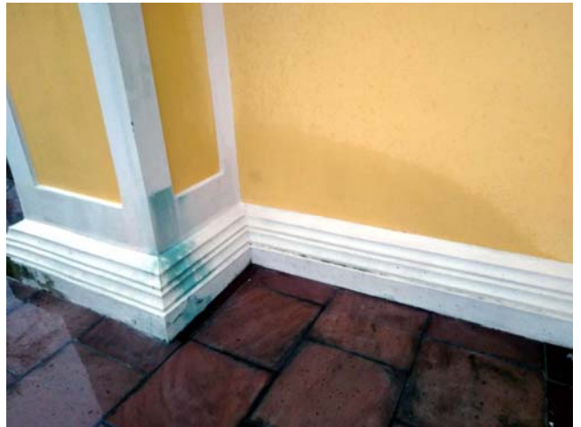
Fot. 5. Zawilgocenie tynku z powodu odprysku wody od twardej nawierzchni. Zielony ślad pochodzi z miedzi, która pokrywa dach i gzymsy
