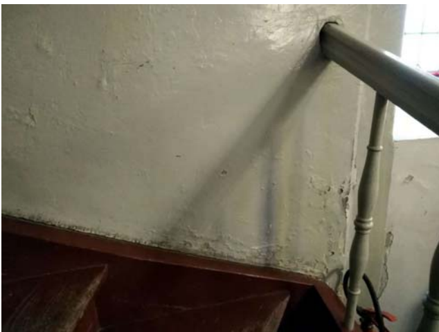
Fot. 6. Złuszczenie się i marszczenie lamperii olejnej przy schodach na chór
