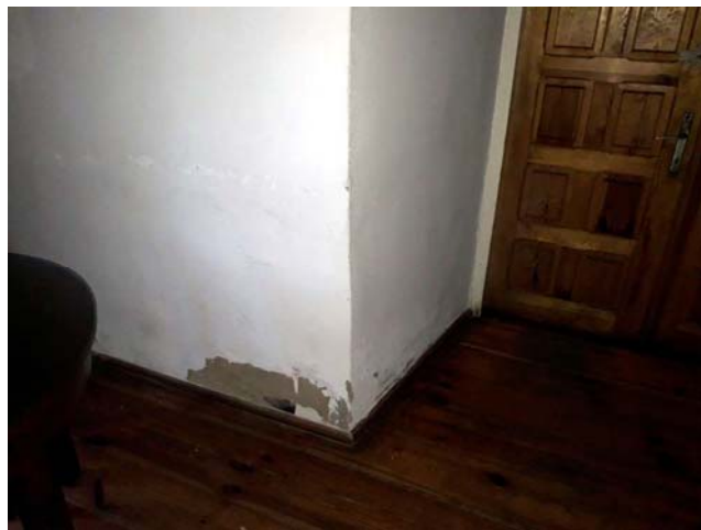
Fot. 11. Wysolenia na tynku w kawiarni przy wejściu do bufetu
