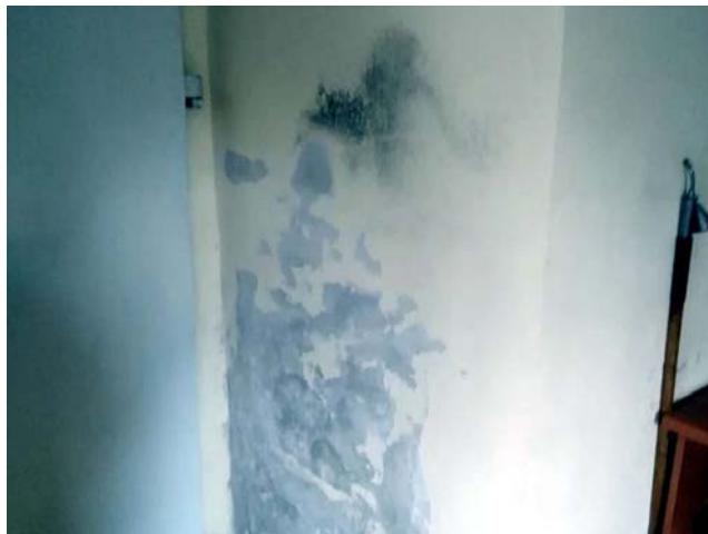
Fot. 10. Kolonie mykoorganizmów (u góry) i uszkodzenia z powodu zawilgocenia (niżej) na powierzchni ściany wejścia z prezbiterium do zakrystii
