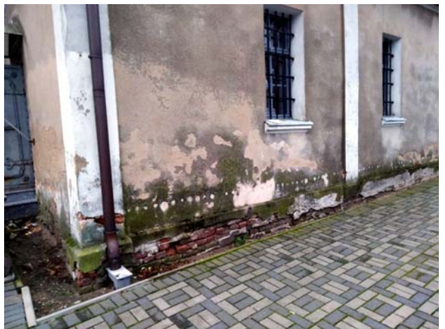
Fot. 5. Tynk na zakrystii. Widoczne ślady po iniekcji i strefa zasolonego tynku. Od północnej strony porastają glony. W pomiarach te ściany są mokre (tab. 6.2)
