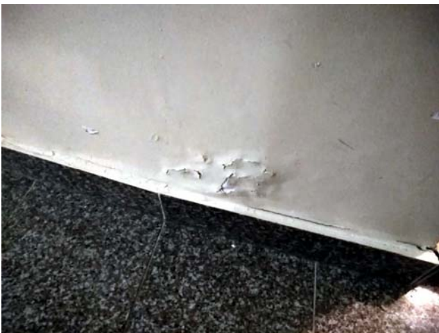
Fot. 6. Wysolenie nad cokółkiem w przejściu do zakrystii - miejsce pomiaru nr 6
