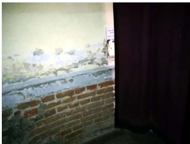
Fot. 4. W przejściu z kruchty do nawy, pomiędzy drzwiami wahadłowymi a kotarą, uszkodzenia powłoki malarskiej, tynk odspojony
