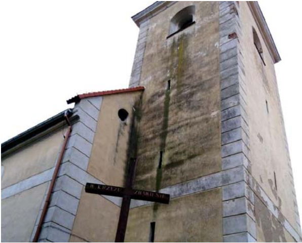
Fot. 2. Uszkodzenia i zacieki na tynku na północnej ścianie wieży
