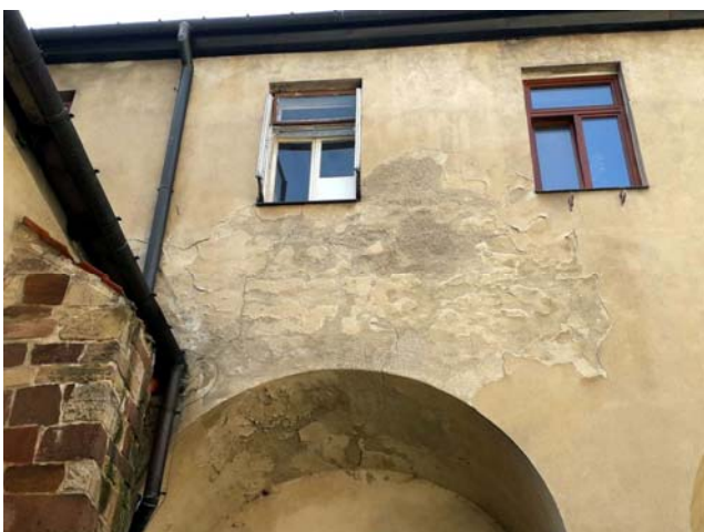
Fot. 5. Wirydarz. Nad miejscem nr 83, na wysokości I piętra uszkodzenia na elewacji świadczące o nieszczelności instalacji wodnych lub kanalizacyjnych
