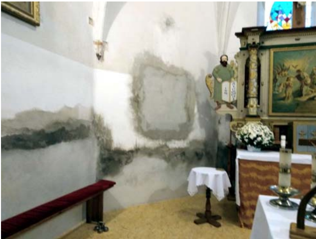
Fot. 4. Uszkodzenia tynku w dolnej strefie naprawiane były wyraźnie innym rodzajem tynku
