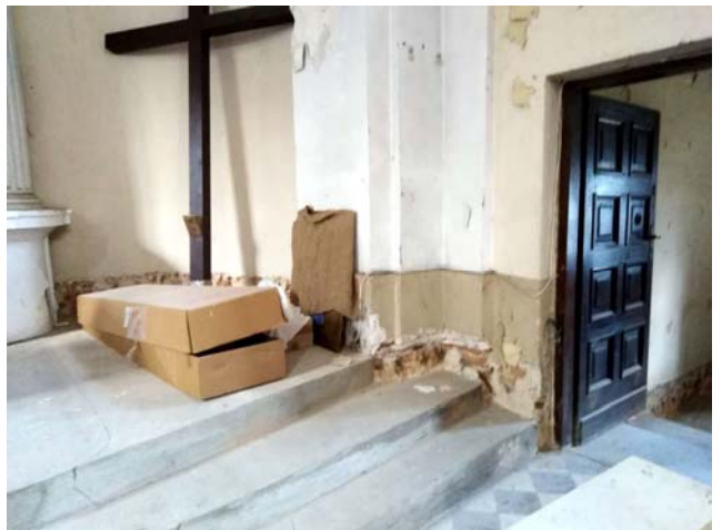
Fot. 5. Tynk wewnątrz jest usunięty miejscami do wysokości ok. 50 cm
