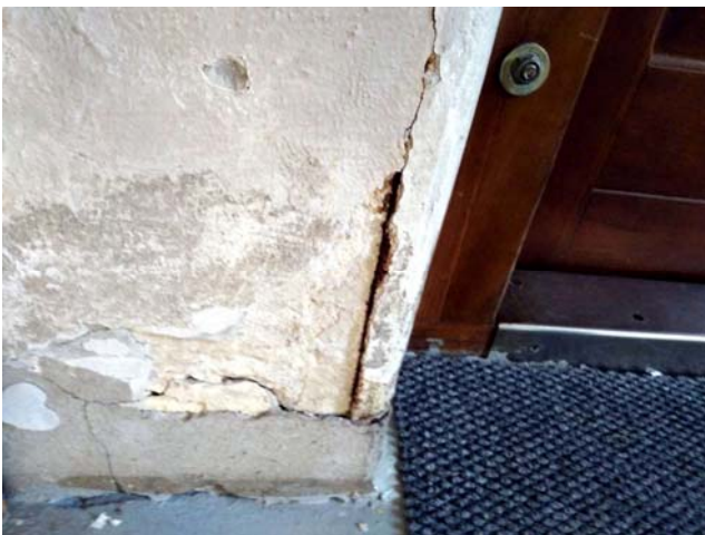
Fot. 4. Uszkodzenia tynku w kruchcie
