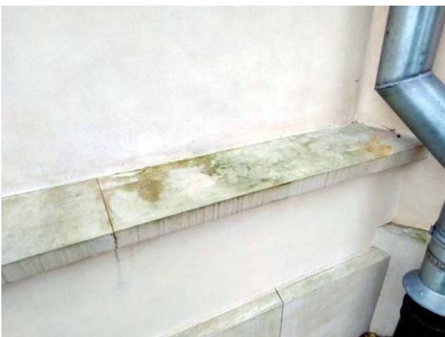
Fot. 6. Zacieki na górnej powierzchni cokołu
