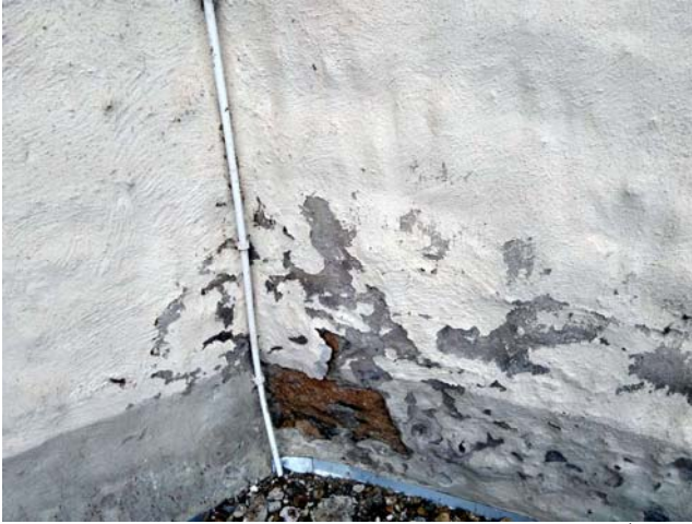
Fot. 2. Uszkodzenia tynku na zewnątrz wschodniej ściany zakrystii odsłaniają kamienie w murze
