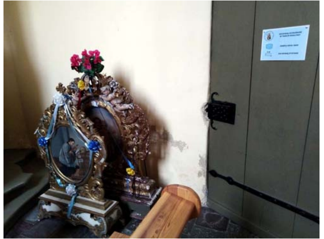
Fot. 5. W zakrystii widoczne złuszczone się wymalowania
