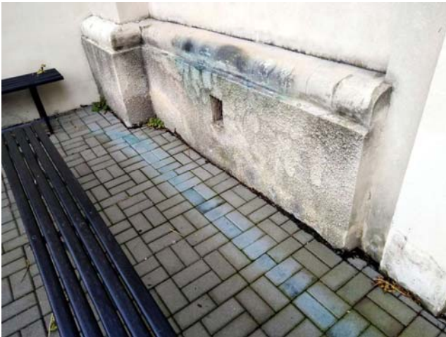
Fot. 4. Zielone ślady na bruku i cokole wskazują na wady miedzianych rynien
