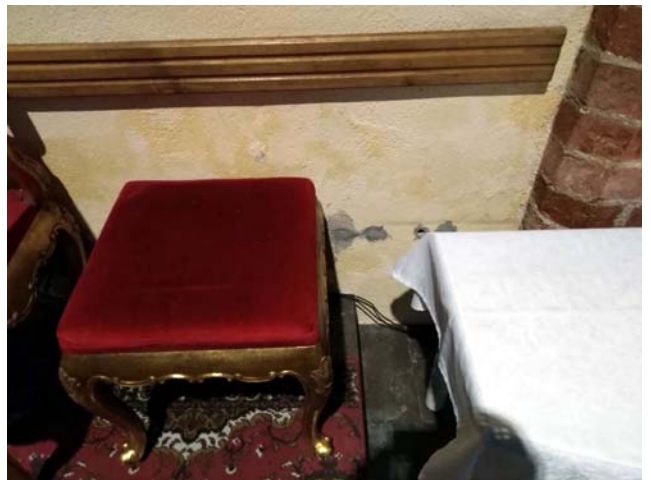
Fot. 7. Na południowej ścianie wewnątrz prezbiterium higroskopijne plamy do wysokości 90 cm
