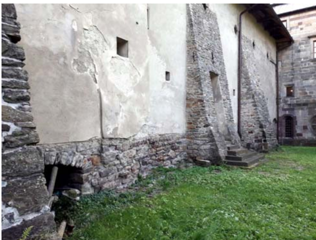
Fot. 16. Uszkodzenia na północnej elewacji domu opata
