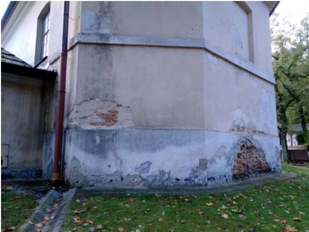
Fot. 2. Uszkodzenia tynku na elewacji prezbiterium
