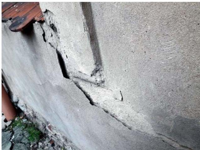
Fot. 6. Wirydarz. Odspojenia tynku. Miejsce nr 85
