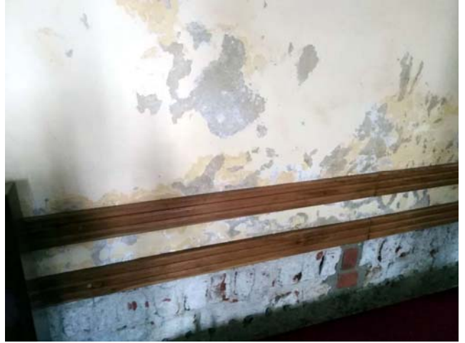
Fot. 3. Na ścianach nawy tynk usunięty od czasu wykonania iniekcji do wysokości 65 cm od posadzki, wyżej widoczne liczne objawy wysoleń
