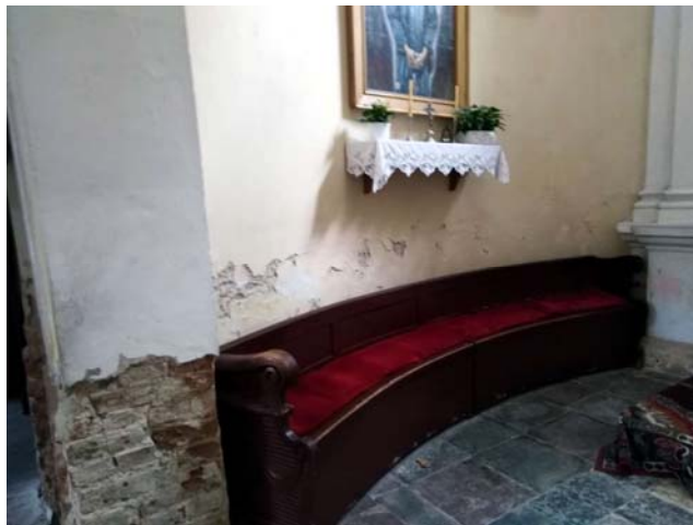
Fot. 3. Na ścianach kaplic tynk usunięty w 2012 r. do wysokości 1 m od posadzki, wyżej widoczne wysolenia
