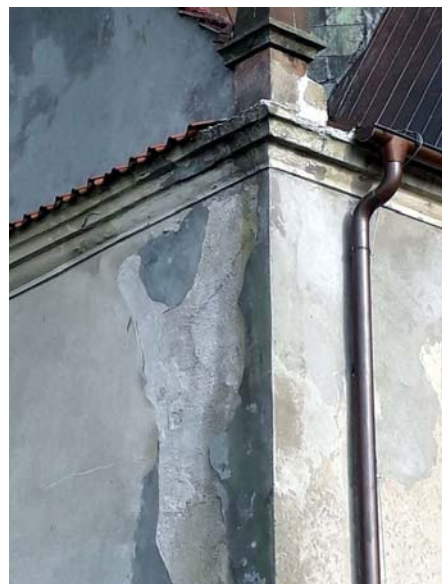
Fot. 17. Ślad zalewania z gzymsu dachowego (brak dachówek) w narożniku kaplicy bł. Wincentego Kadłubka. Miejsce nr 146
