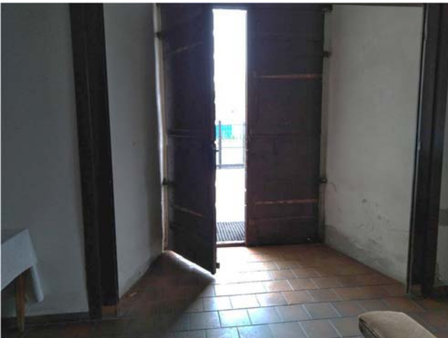
Fot. 4. Uszkodzenia związane z zawilgoceniem na ościeżu drzwi zewnętrznych do kruchty (punkt pomiarowy nr 13)
