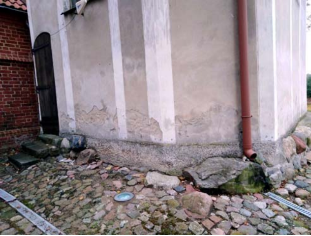
Fot. 2. Uszkodzenia tynku na zewnętrznych ścianach kaplicy św. Józefa
