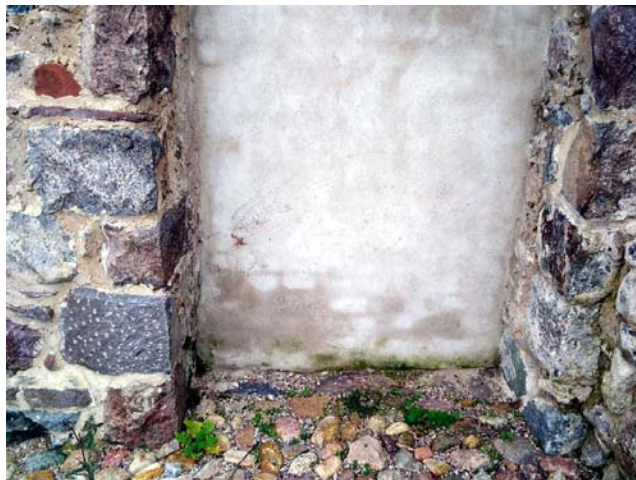
Fot. 5. Na tynku, w zamurowanym portalu, który dawniej prowadził do zakrystii, wyraźne zawilgocenia
