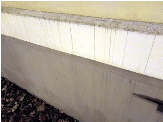
Fot. 2. Pomimo hydrofobizacji widać brudne ślady zaciekającej wody deszczowej
