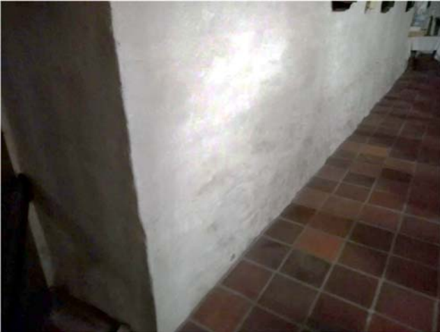
Fot. 3. Przebarwienia tynku w dolnej części ścian nawy
