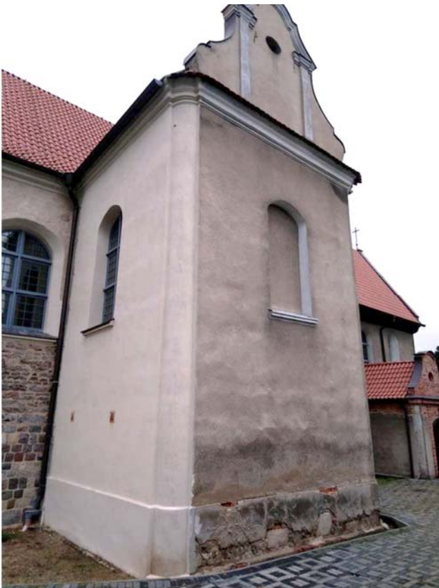
Fot. 4. Ściany kościoła są częściowo odnowione. Na starym tynku widać wyraźną strefę zawilgocenia i zasolenia. Na nowym tynku już także widać skutki działania wody odpryskowej. Kaplica Matki Bożej Szkaplerznej od strony północnej.
