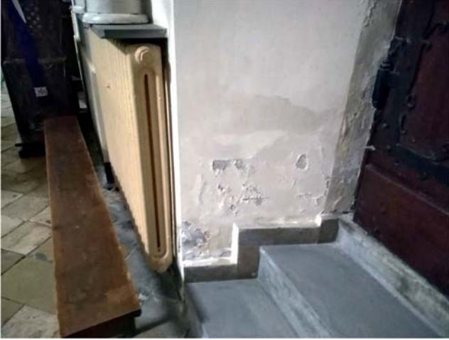
Fot. 2. Uszkodzenia tynku w nawie, przy wejściu północnym
