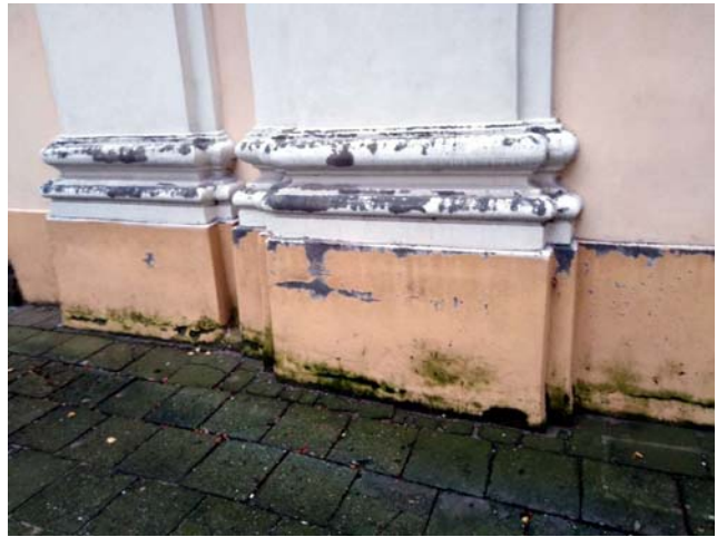
Fot. 5. Fasada zachodnia przy wejściu głównym. Widoczne ślady glonów, które są zasilane odpryskiem wody od płyt chodnika. Brak powłoki hydrofobowej na gzymsach
