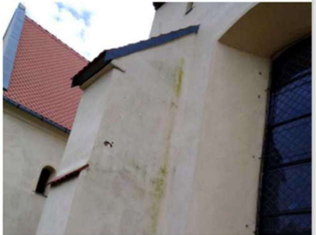
Fot. 7. Glony rosnące w kącie pomiędzy elewacją a przyporą. Skutek zalewania tego miejsca z krawędzi zadaszenia przypory.
