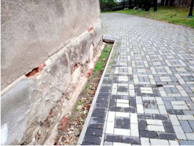
Fot. 2. Resztki tynku prawdopodobnie cementowo-wapiennego
