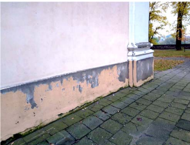
Fot. 6. Cokół północnej ściany wieży zalewany jest wodą deszczową
