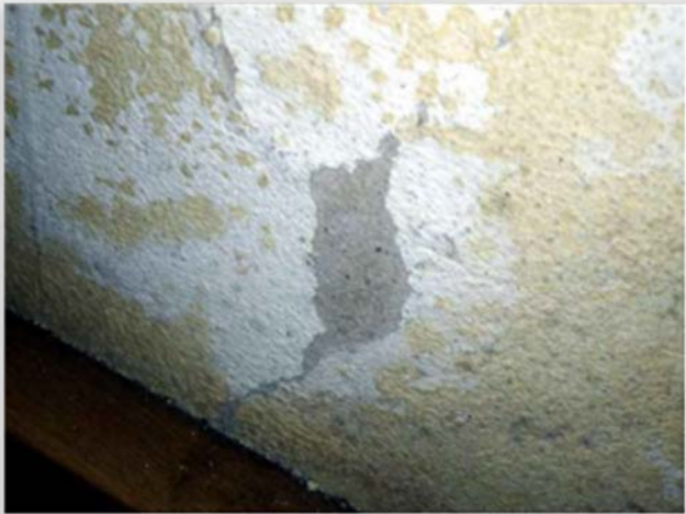
Fot. 2. Przebarwienia tynku w dolnej części ścian nawy.
