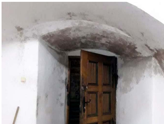
Fot. 3. Uszkodzenia w kuchni związane są ze skraplaniem się pary wodnej na ścianie (kondensacja)
