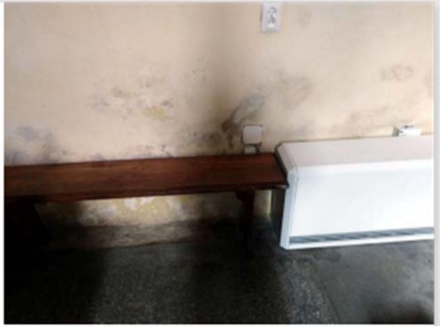
Fot. 3. Uszkodzenia i mykoorganizmy na powierzchni tynku w nawie.
