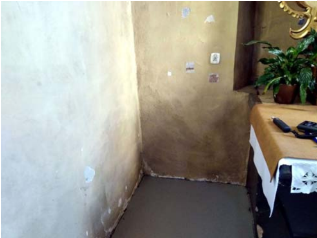
Fot. 2. Ściany kaplicy św. Barbary są pomalowane żółtą powłoką monochromatyczną, która zmarszczyła się, odsłaniając dawną malaturę. Widoczne są ślady odkrywek konserwatorskich. Te ślady po obu stronach ołtarza w kaplicy
