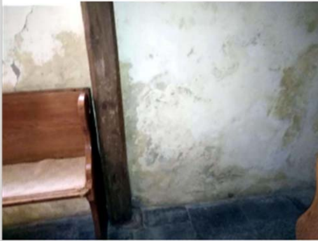
Fot. 4. Uszkodzenia i mykoorganizmy na powierzchni tynku w nawie.
