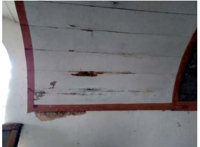
Fot. 3. Ślady zawilgocenia w pobliżu krawędzi desek na stropie
