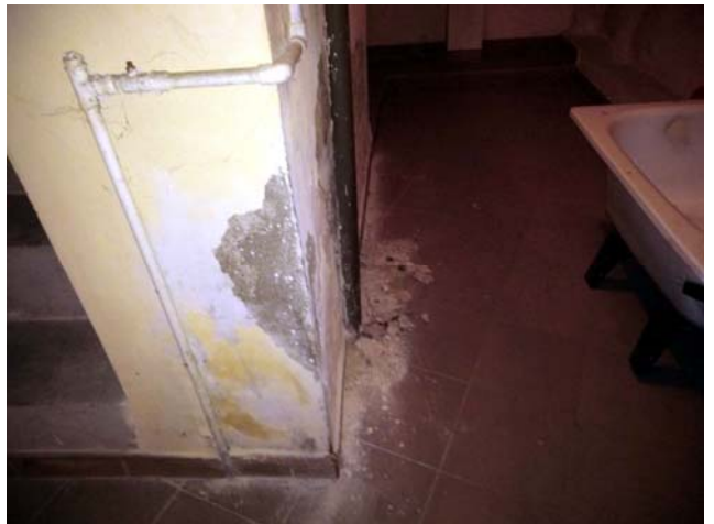
Fot. 5. Wysolenia na ścianach w krypcie
