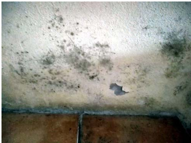
Fot. 9. Kolonie mykoorganizmów na ścianie zakrystii
