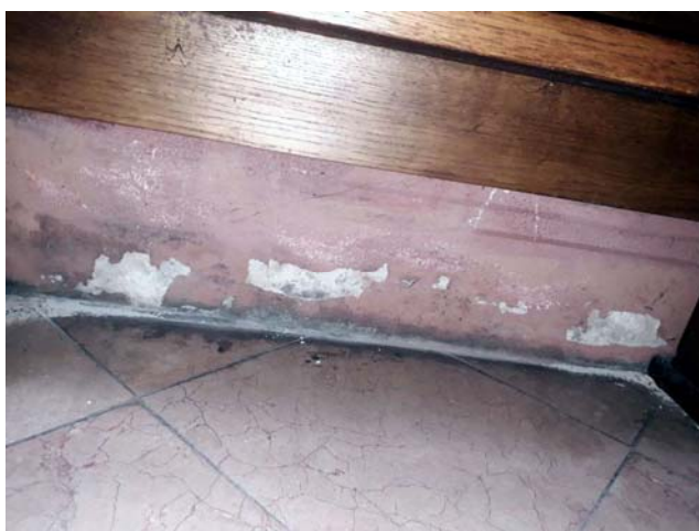
Fot. 9. Uszkodzenia tynku pod ławkami w nawie. Miejsce nr 2
