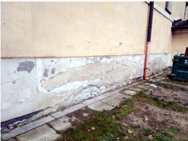
Fot. 4. Uszkodzenia tynku w strefie cokołu
