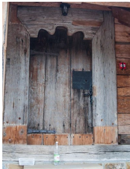
106. Rudka, pow. przeworski. Cerkiew Zaśnięcia Matki Bożej. Portal główny od zach. pocięty i uzupełniony nowym drewnem podczas remontu. W miejscu oryginalnego wrzędu nowa klamka, nad portalem „retro” lampa, całość wmontowana w nowy babiniec. Fot. A. Żygadło, 2014. Zbiory autora.
