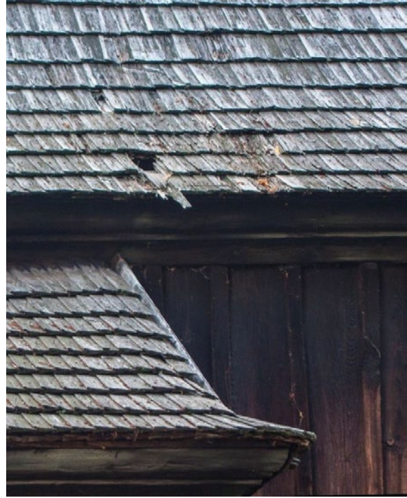
39. Krzczowice, pow. przeworski. Cerkiew św. Mikołaja, widok fragmentu pd. elewacji. Widoczne ubytki i zniszczenia gontowego pokrycia połaci dachu. Fot. A. Żygadło, 2022. Zbiory autora.
