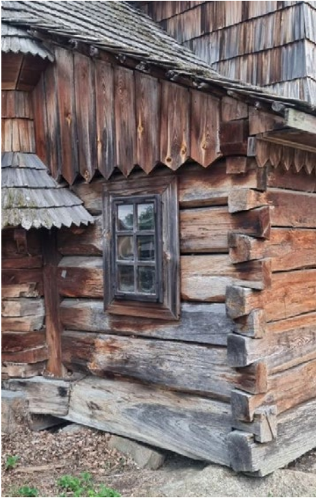
35. Łukawiec, pow. lubaczowski. Cerkiew św. Dymitra Męczennika. Widok zakrystii od pn.-wsch. Widoczny brak wiatrownicy osłaniającej krawędź dachu zakrystii. Z krawędzi dachu wystają zniszczone ostatki łąt. W lewym dolnym rogu widać nieokopaną podwalinę sanktuarium. Fot. A. Żygadło, 2022. Zbiory autora.
