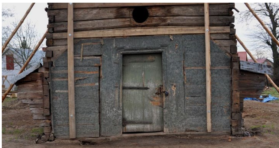
72. Leżachów, pow. przeworski. Cerkiew św. Nikity, widok od pn.-zach. Widoczna podwalina całkowicie osiadła w ziemi, rysie przycięte w 1884 r. przy ścianie pn.-wsch. i pd.-zach. oraz ślady po całkowicie obciętych ryskach przy ścianie pn.-zach. Fot. A. Żygadło, 2015. Zbiory autora.
