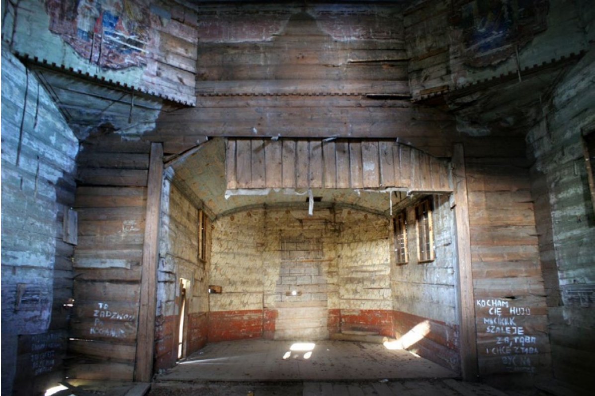
25. Mięgisz Stary, pow. jarosławski. Cerkiew Opieki Matki Bożej. Widok na zdewastowane wnętrze świątyni od zach. Widoczne wulgarne napisy na ścianach. Fot. D. Nowak, 2010. Zbiory autora.
