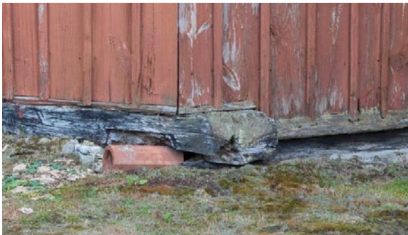
31. Szczutków, pow. lubaczowski. Cerkiew św. Dymitra. Posadowienie, węglowania zach. i pn.-zach. ściany transeptu; nieokopane, zapadłe, z niedostatecznym fartuchem. Fot. A. Żygadło, 2022. Zbiory autora.
