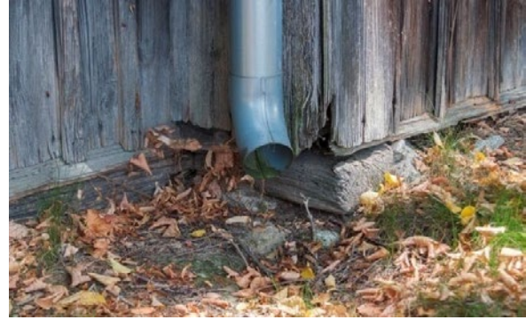
30. Moszczanica, pow. lubaczowski. Cerkiew św. Michała Archanioła. Węglowania ścian: pd. babińca i zach. nawy oraz zach. nawy i pd. nawy; nieokopane, zapadłe, z niedostatecznym fartuchem i rynną odprowadzającą wodę wprost pod posadowienie. Fot. A. Żygadło, 2022. Zbiory autora.
