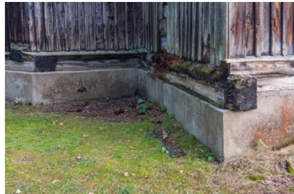
71. Łówcza, pow. lubaczowski. Cerkiew św. Paraskewy. Widok na pn. ścianę sanktuarium i wsch. ścianę zakrystii. Widoczna betonowa opaska, przegniła podwalina, zniszczony, niedostateczny fartuch i ubytki w deskowaniu. Fot. A. Żygadło, 2022. Zbiory autora.
