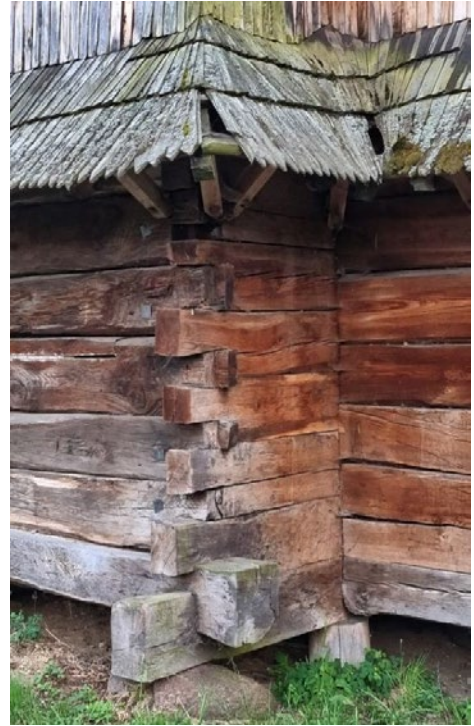
36. Łukawiec, pow. lubaczowski. Cerkiew św. Dymitra Męczennika. Widok węglowania pn. i zach. ściany nawy oraz zach. ściany nawy i pn. babińca. Widoczne ubytki w gontowym pokryciu daszku opasania i węglowanie podwaliny zawilgocone w skutek ubytków pokrycia, oraz – zapewne – niewystarczającego zasięgu okapu. Fot. A. Żygadło, 2022. Zbiory autora.
