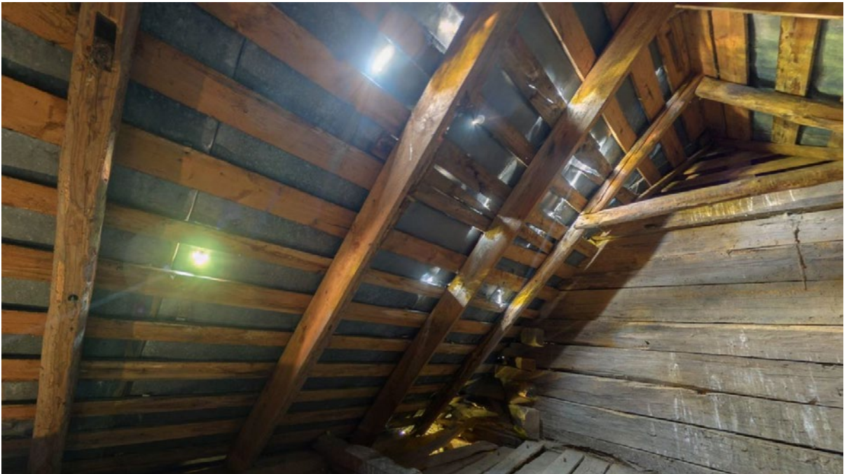
37. Mięksisz Stary, pow. jarosławski. Cerkiew Opieki Matki Bożej. Widok poddasza sanktuarium od pn.-wsch. Widoczny zrąb tamburu kopuły nad nawą, zniszczona podłoga poddasza, krokwie dachu z wyraźnymi śladami przebudowy i liczne ubytki blaszanego pokrycia połaci dachowych. Fot. A. Żygadło, 2020. Zbiory autora.
