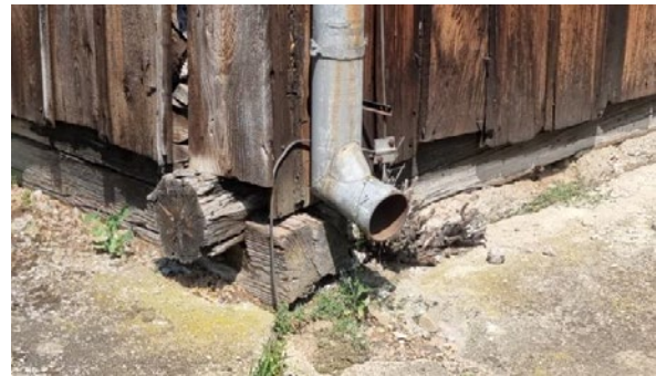
32. Grabowiec, pow. jarosławski. Cerkiew Przemienienia Pańskiego, węglowania: pd. i wsch. ścian nawy, zapadłe, bez fartucha, spięte betonowym chodnikiem, z rynną odprowadzającą wodę pod posadowienie. Fot. A. Żygadło, 2022. Zbiory autora.
