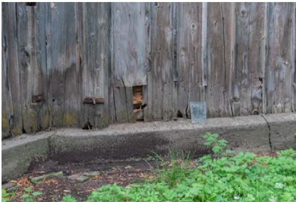
70. Tyniowice, pow. jarosławski. Cerkiew św. Dymitra. Widok na pd.-zach. ścianę nawy. Widoczne: betonowa opaska spinająca podwalinę, zniszczone dolne partie deskowania oraz próchno belek wyzierające z ubytków deskowania. Fot. A. Żygadło, 2022. Zbiory autora.
