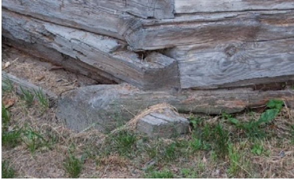
29. Mięksisz Stary, pow. jarosławski. Cerkiew Opieki Matki Bożej. Posadowienie, węglowania pd. i pd.-wsch. ściany sanktuarium, nieokopane, nieosłonięte fartuchem. Podwaliny do połowy poniżej poziomu gruntu. Fot. A. Żygadło, 2022. Zbiory autora.
