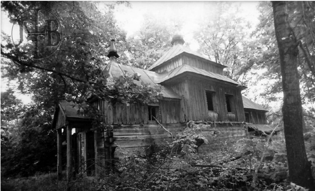
40. Wólka Żmijowska, pow. lubaczowski. Cerkiew Narodzenia Matki Bożej, widok od pd.-zach. Zabytek uszkodzony powalonym przez burzę drzewem w 1989 r. Widoczne oberwane opasanie przy ścianach nawy i babińca. Uszkodzenia zostały stosunkowo szybko usunięte poprzez rekonstrukcję zniszczonego opasania. Fot. J. Tur 1989. ZAJTiBT, sygn. bn.
