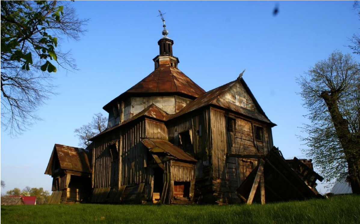
5. Mięgisz Stary, pow. jarosławski. Cerkiew Opieki Matki Bożej od pn.-zach., po zawaleniu się kruchty przed zach. wejściem w 2010 r. Zrujnowany obiekt z widocznym brakiem zach. ściany zakrystii, z ruiną kruchty pn. (rozebraną w 2021) i ruinami kruchty zach. Fot. D. Nowak, 2010. Zbiory autora.
