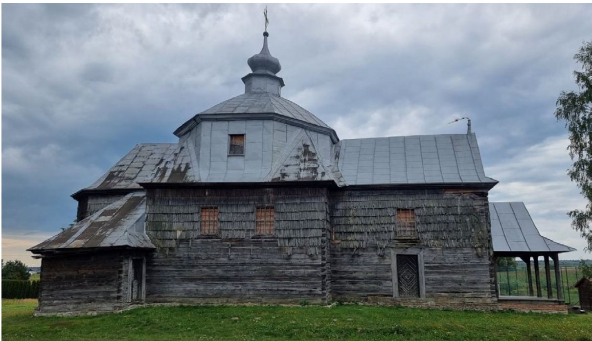
10. Cewków, pow. lubaczowski. Cerkiew św. Dymitra, widok od pn. Widoczna destrukcja gontowego opierzenia ścian, zniszczonego doszczętnie w dolnych partiach. Ponad pn. wejściem do babińca zniszczone bierwiono w miejscu gdzie pierwotnie znajdował się pulpitowy daszek. Ściany obiektu narażone na destrukcyjne działanie warunków atmosferycznych powoli niszczeję. Przed głównym wejściem widoczne zadaszenie na słupach, odbudowane w ostatnich latach. Fot. A. Żygadło, 2022. Zbiory autora.
