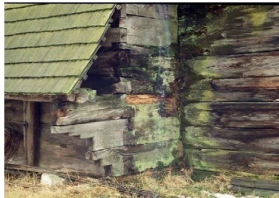
7. Rudka, pow. przeworski. Cerkiew Zaśnięcia Bogarodzicy. Pn.-zach. węglowanie ścian nawy i babińca zniszczone wskutek niedostatecznego zabezpieczenia i zbyt długiego oczekiwania na prace remontowe po katastrofie obiektu w 1988 r. Fot. A. Żygadło, 2004. Zbiory autora.
