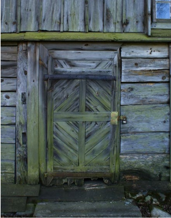
38. Żmijowiska, pow. lubaczowski. Cerkiew Zaśnięcia Matki Bożej, widok pn. wejścia do zakrystii. Widoczne zazielenienie nieosłoniętych ścian, pokrytych glonami świadczące o długotrwałym, wysokim poziomie wilgotności materiału. Fot. D. Nowak, 2010. Zbiory autora.
