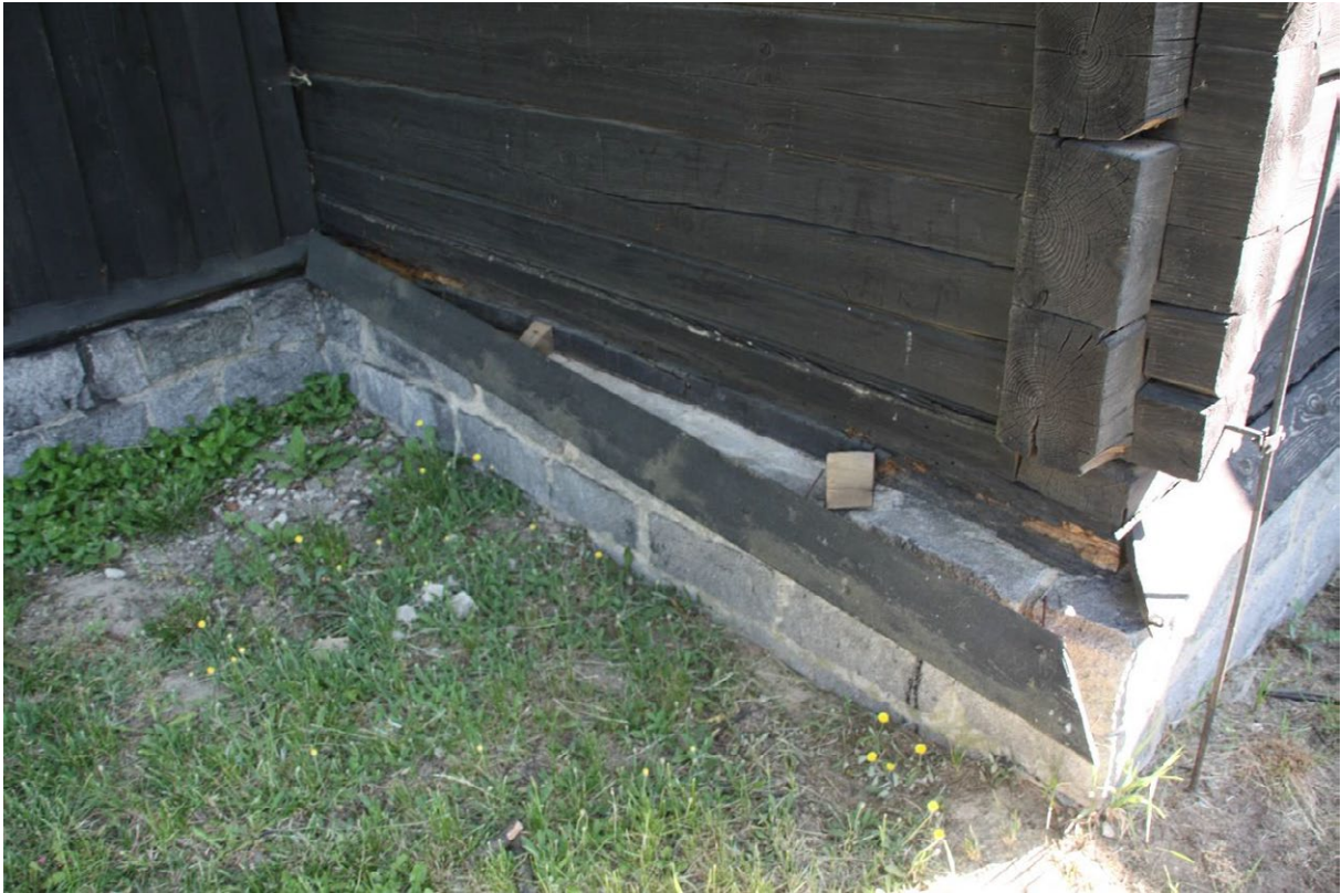
Fotografia nr 14 Wierzbica Dolna, deska okapowa. Kościół na fundamencie z bloków granitowych, w 1939 r. zrekonstruowany na wzór wcześniejszego, fot. G. Naumowicz
