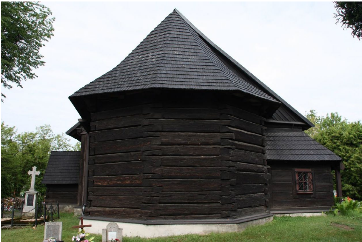
Fotografia nr 11 Maciejów, zręqb poczerziony, podmurówka otynkowana zaprawami cementowymi, fot. G. Naumowicz
