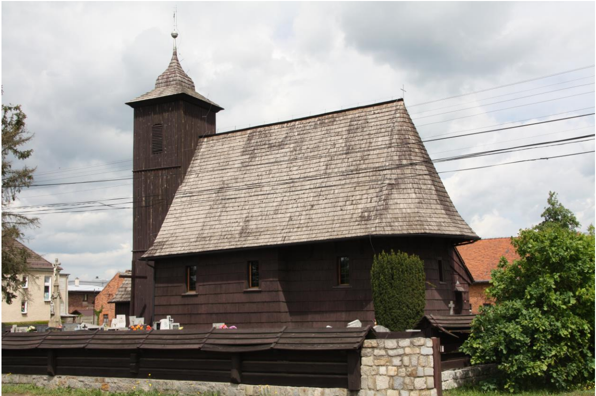
Fotografia nr 3 Lasowice Wielkie, brak bieżącej impregnacji pokrycia dachowego, fot. G. Naumowicz
