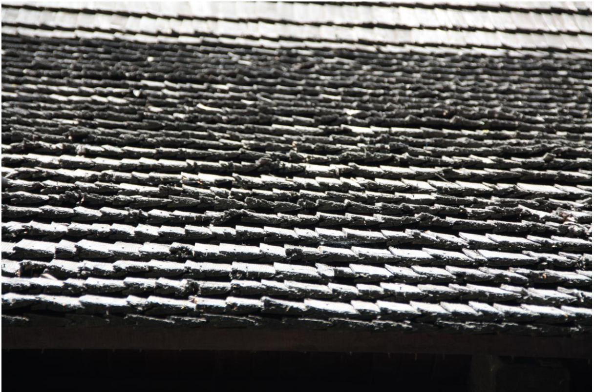
Fotografia nr 9 Biskupów, destrukcja gontu, fot. G. Naumowicz
