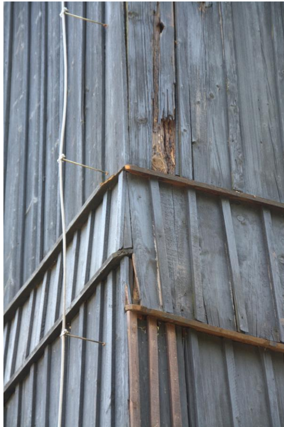
Fotografia nr 23 Gierałtice, zniszczenia konstrukcji słupowej wieży, odsłonięte w miejscu, gdzie destrukcji uległo szalowanie, fot. G. Naumowicz
