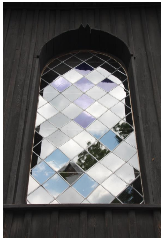
Fotografia nr 2 Laskowice, całkowite zasłonięcie oboknia oraz ościeżnicy, deformacja szklenia w ołowiu, fot. G. Naumowicz
