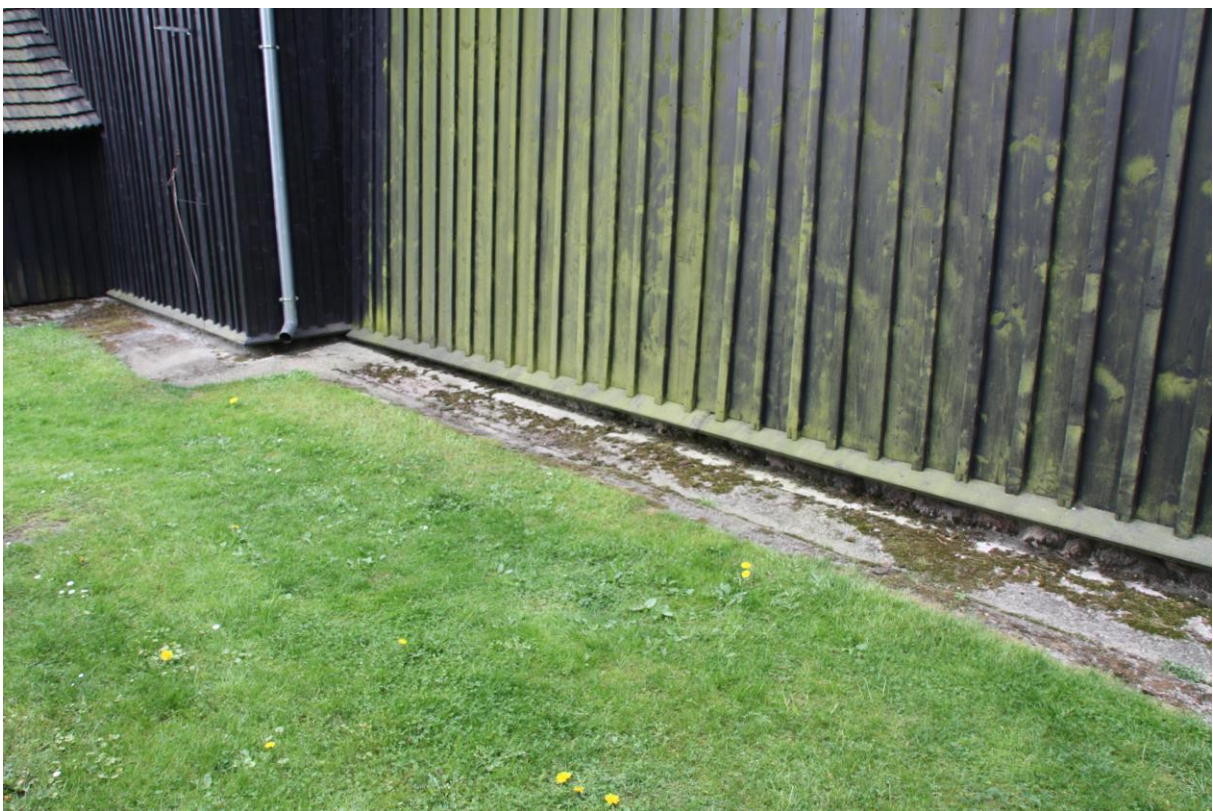
Fotografia nr 31 Proślice, spękana opaska betonowa, rury spustowe tuż przy ścianach kościoła, fot. G. Naumowicz
