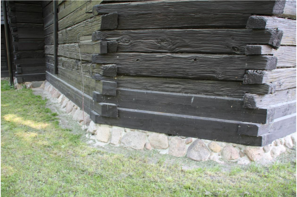
Fotografia nr 20 Świniary Wielkie, wymiana podwalin, belek zrębu, powierzchniowa naprawa bierwion, przywrócenie podmurówki do pierwotnego stanu, fot. G. Naumowicz
