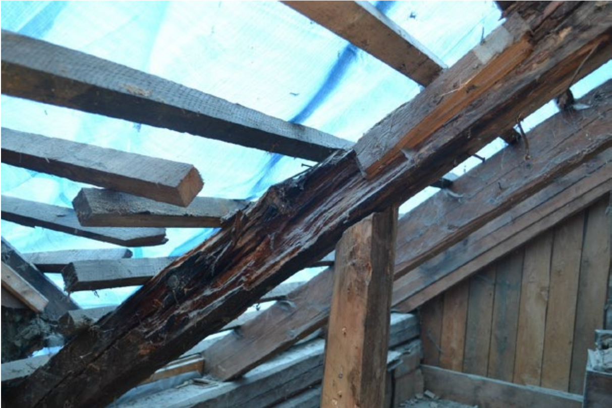
51. Korozja krokwi, Willa „Jadwińówka I”, drew., 1886; wpis do rejestru zabytków A-437 z dn. 24.01.1986 i [A-66/M] z dn. 09.10.2006, fot. N. Skiepmo 2020
