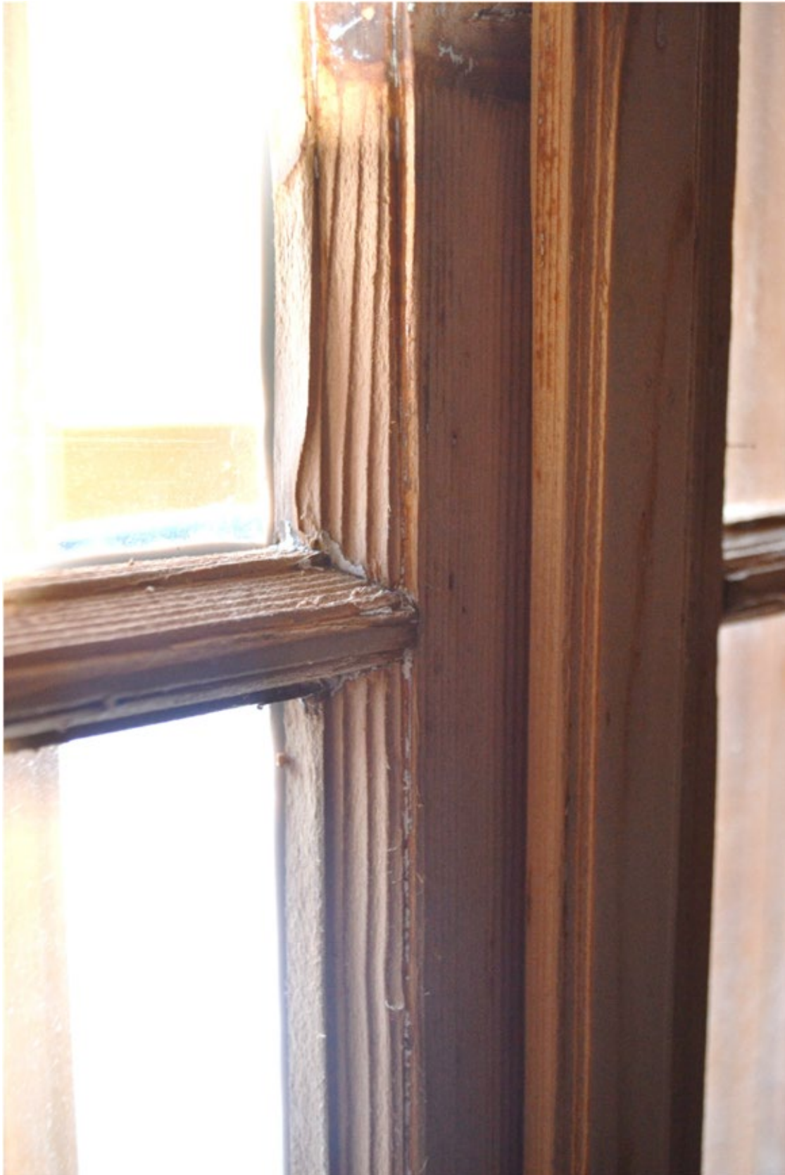
53. Oryginalne stolarki okienne zniszczone piaskowaniem mechanicznym, niedoczyszczone powłoki malarskie, brak danych
