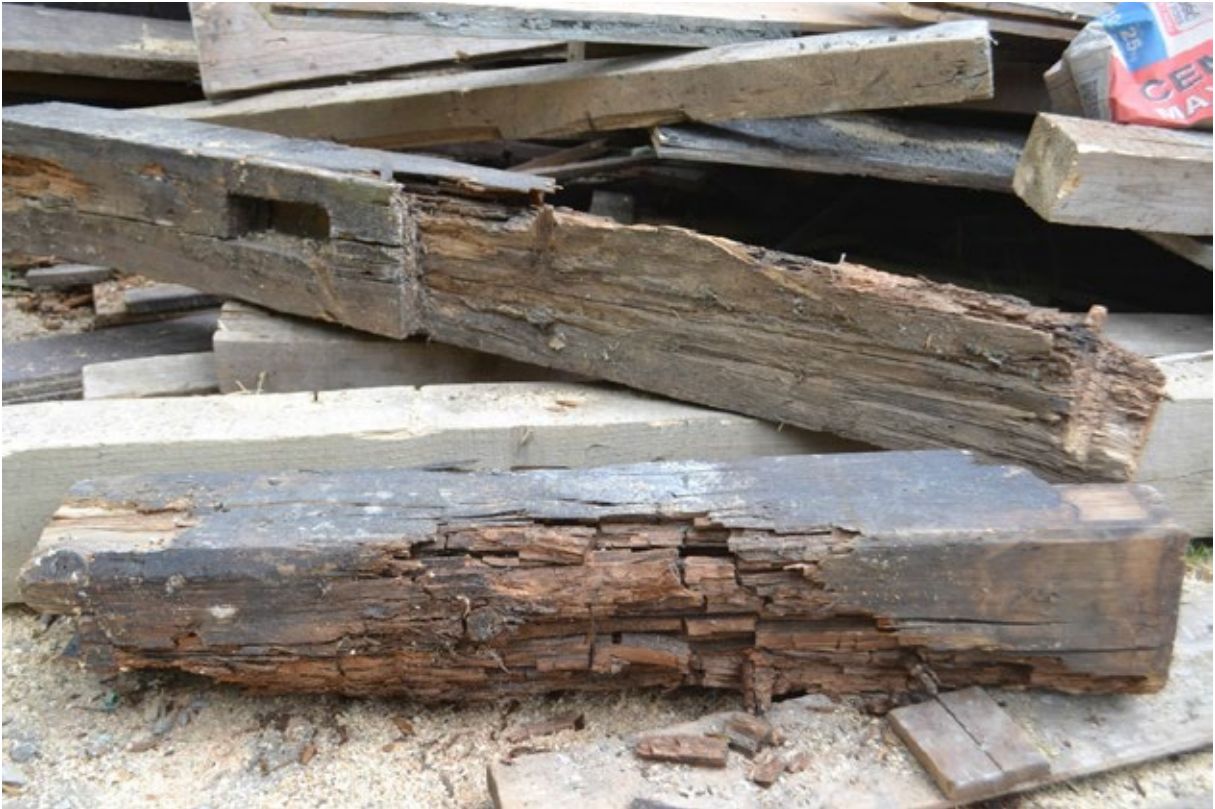
49. Willa „Jadwiniówka I”, drewn., 1886; wpis do rejestru zabytków A-437 z dn. 24.01.1986 i [A-66/M] z dn. 09.10.2006, korozja podwalin ganku, fot. N. Skiepmo 2019
