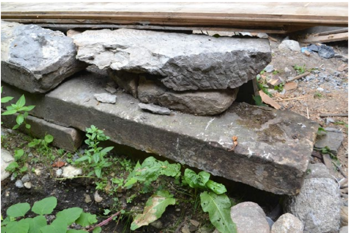
48. Willa „Jadwiniówka I”, drew., 1886; wpis do rejestru zabytków A-437 z dn. 24.01.1986 i [A-66/M] z dn. 09.10.2006, wyrzucone stare oryginalne stopnie, fot. N. Skiepmo 2019
