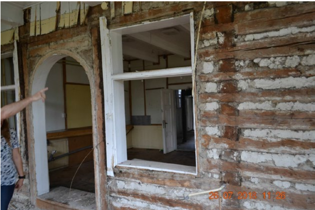
16. Zespół Szkół Zawodowych, d. Pensjonat „Szafas”, 1897, widoczny słabej jakości materiał, pospiesznie wzniesiona konstrukcja, przygotowana pod szalowanie, fot. N. Skiepmo 2018
