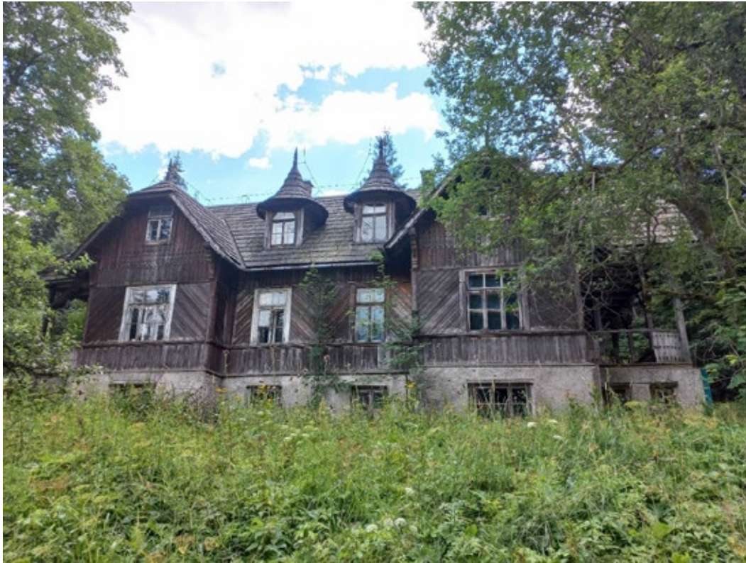
24. Willa „Leontynówka”, drew., ok. 1893; wpis do rejestru zabytków [A-1308/M] z dn. 10.10.2012, fot. N. Skiepmo 2022
