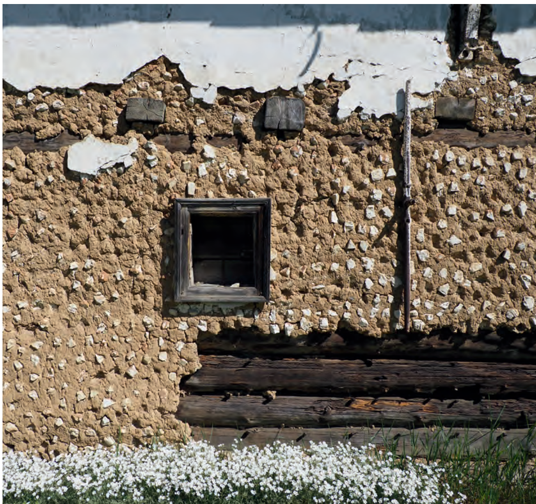
Uszkodzenia glinianych tynków pokrywających pierwotnie ściany drewniane, fot. K. Latocha
