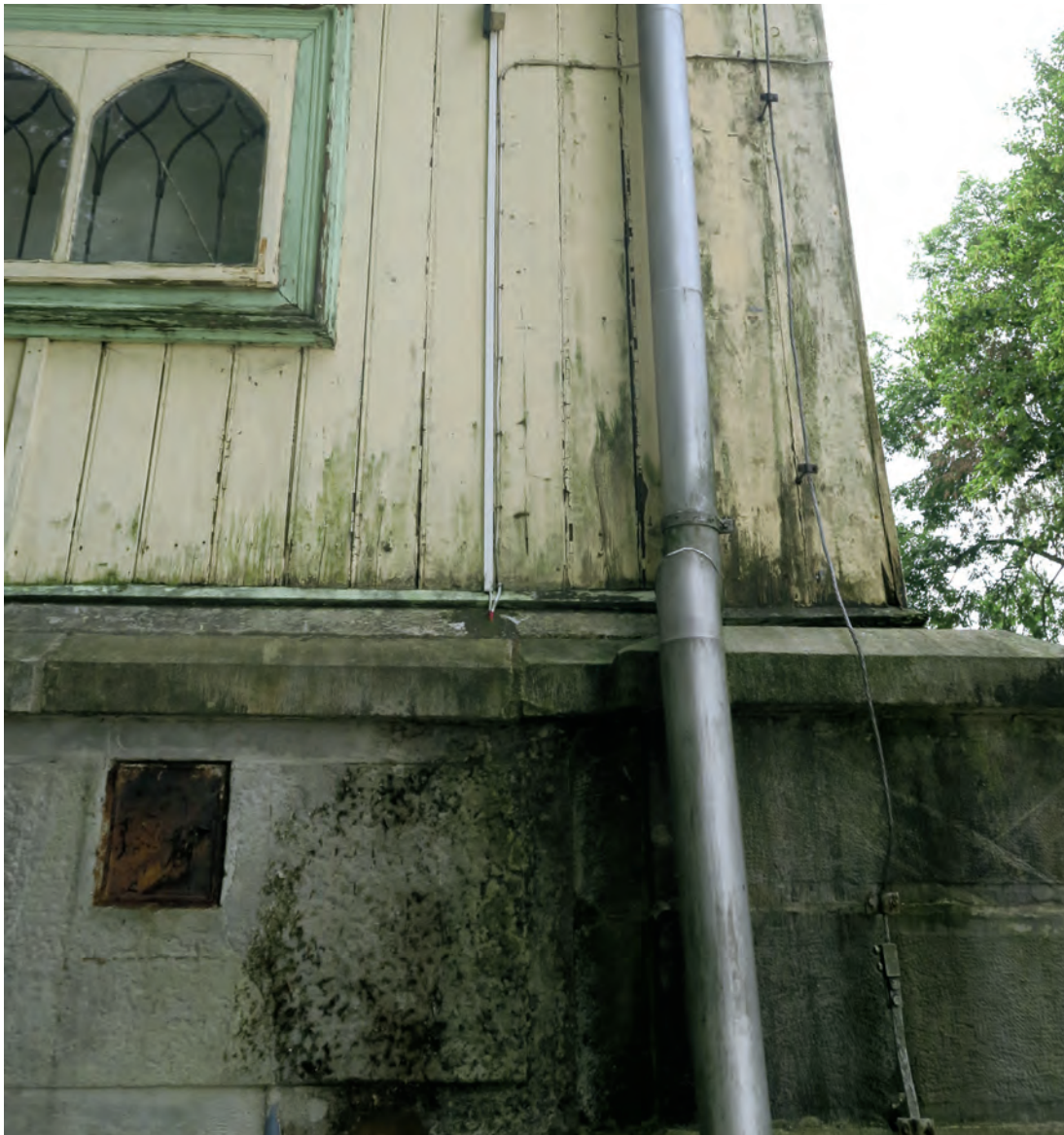
Uszkodzenia podmurówki oraz elementów drewnianych ścian i szalunku spowodowane nieszczelnościami rur spustowych i odwodnienia dachu, fot. A. Fortuna-Marek
