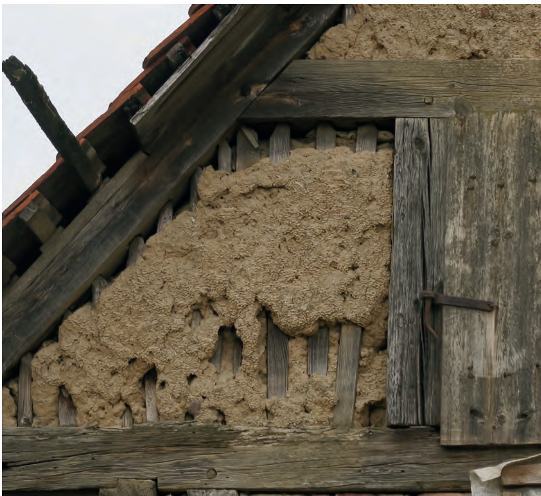
Uszkodzenia wypełnień konstrukcji szkieletowej, fot. T. Błyskosz
