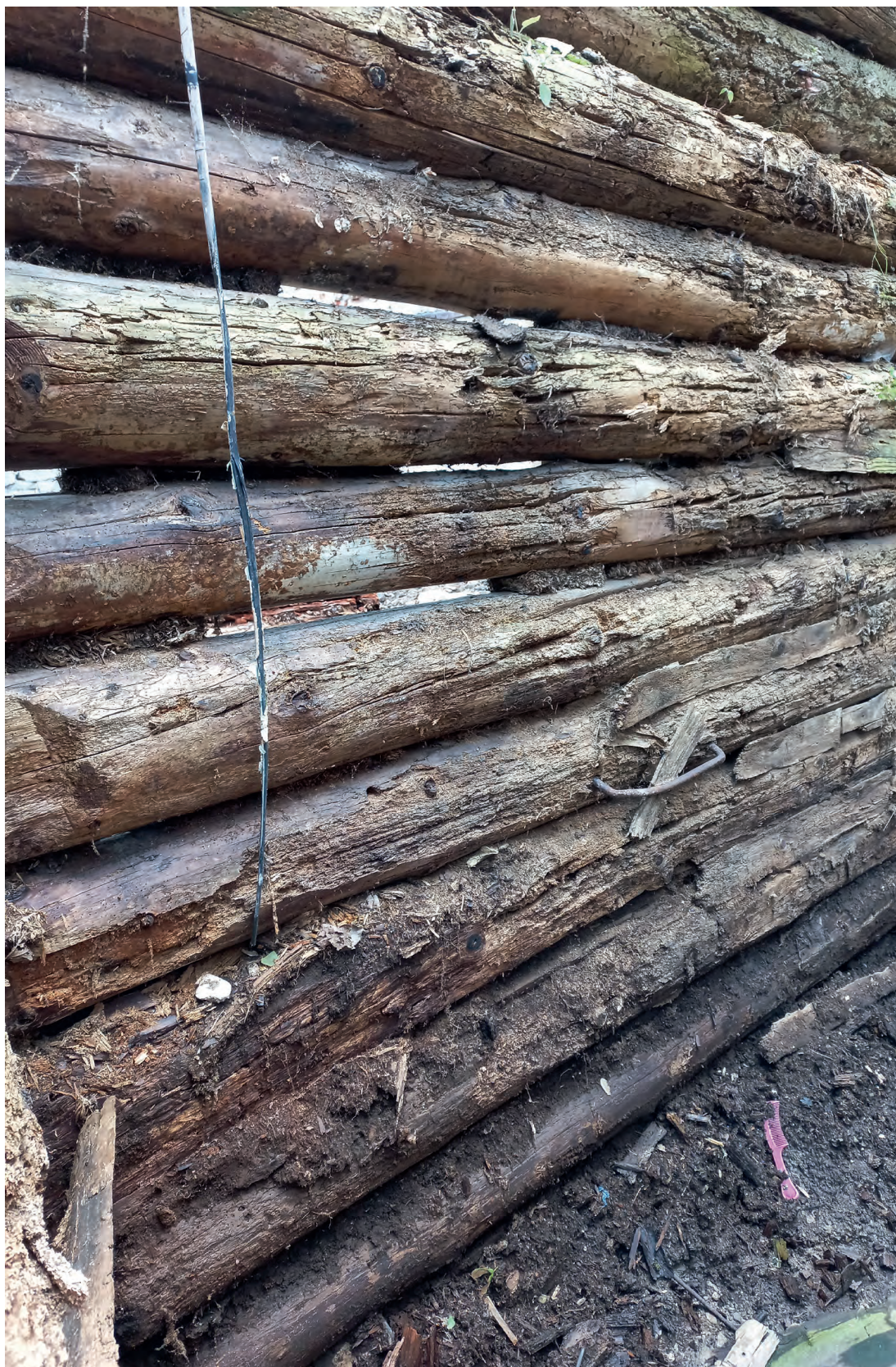
Silne zniszczenia biologiczne elementów drewnianych ścian budynku, fot. N. Skiepmo
