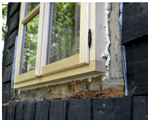
Montaż nowej stolarki okiennej niedostosowanej do pierwotnej formy szalunków ścian oraz przy użyciu współczesnych technologii, fot. N. Skiepmo
