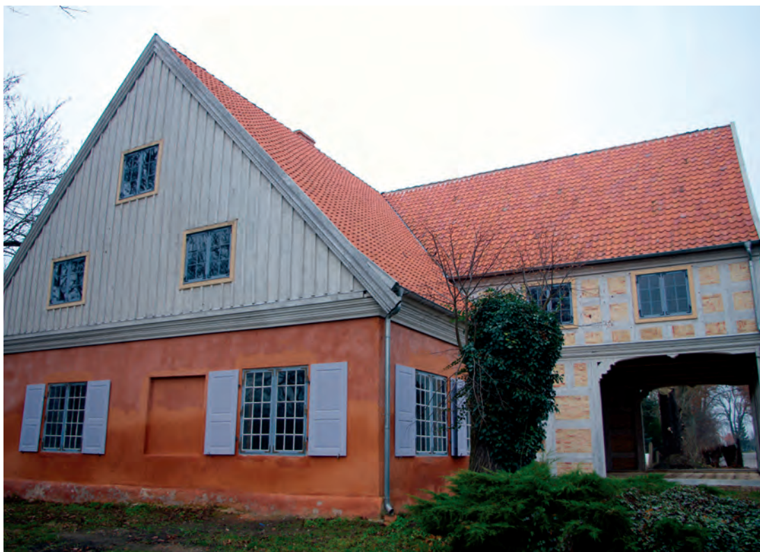
Żułowski dom podcieniowy w Złotowie po przeprowadzonych poprawnie pracach remontowych, stan z 2013 i 2020 r., fot. F. Gawliński
