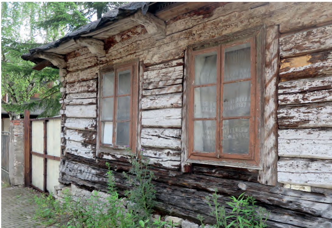
Uszkodzenia biologiczne bierwion konstrukcji ścian budynku, fot. A. Olczyk
