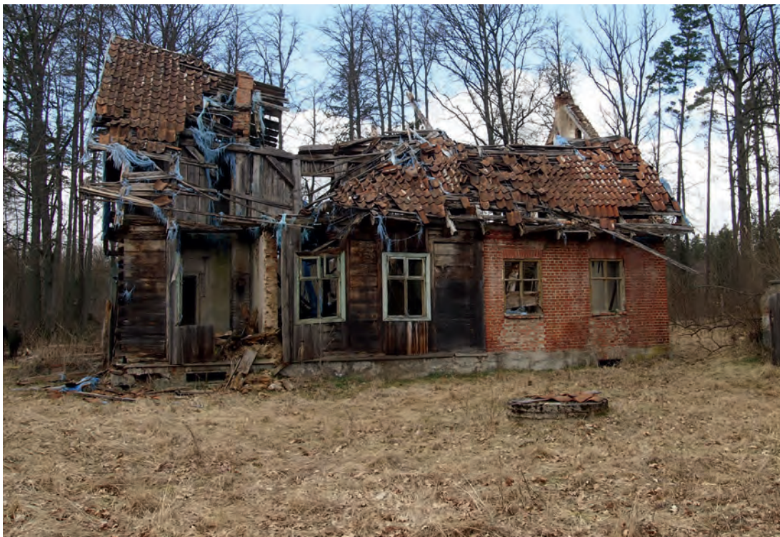
Katastrofalny stan zachowania zabytkowej leśniczówki pozbawionej funkcji i nieużytkowanej, fot. A. Płoski
