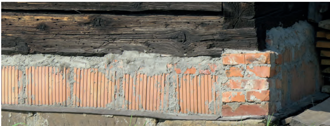
Nieprawidłowa naprawa ścian drewnianych polegająca na zastąpieniu zniszczonych bierwion materiałem ceramicznym i cementem, skutkująca w przyszłości dalszymi zniszczeniami drewna, fot. A. Laskowski
