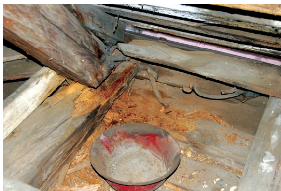
Zniszczone przez korozję biologiczną połączenie belki stropowej z krokwią uległo całkowitej dezintegracji. Drewno zostało w zasadzie sproszkowane. Elementy konstrukcyjne są do wymiany. Ocena wizualna nie pozwala na stwierdzenie stopnia destrukcji, ale można zakładać, że jest ona większa, niż to widoczne.
