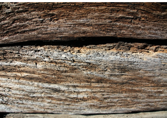
Belki ściany wieńcowej porażone przez szkodniki techniczne drewna (najprawdopodobniej przez kołatka). Fot. G. Naumowicz
