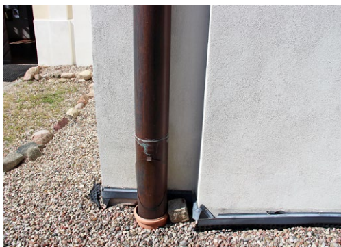
Fot. 4a, b, c Listwy naścienne zamykające napływ wody za folię, stosowane są niekonsekwentnie, bywają niekompletne i przez to nieskuteczne
