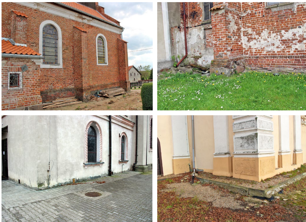
Fot. 5a, b, c, d Brak odpowiednich spadków, przegłębienia, twarde nawierzchnie, przypadkowe przeszkody to także częsta przyczyna kłopotów z zawilgoceniem
