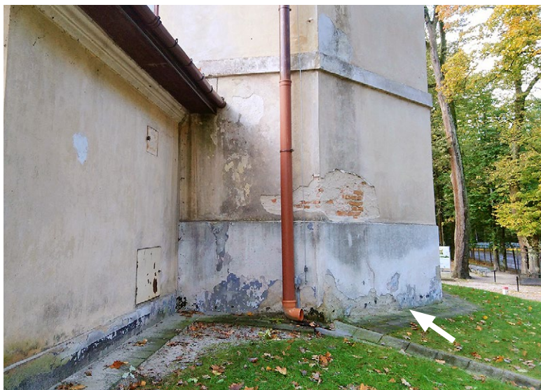
Fot. 3a, b Izolacje poziome także bywają nieciągłe, niekonsekwentne, a czasem wręcz niszczące zabytkową substancję
