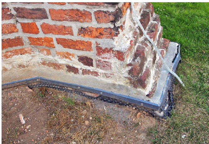
Fot. 9 W tym samym obiekcie – poprawnie założona folia grzybkowa zakończona listwą zamykającą. Jednak po latach procesy starzenia nietrwałego tworzywa sprawiły, że folia już się rozleciała i między nią a listwą jest wyraźna szczelina. W rezultacie woda wpływa za listwę przy każdym deszczu, dodatkowo nawilżając strefę fundamentową tej 700-letniej budowli
