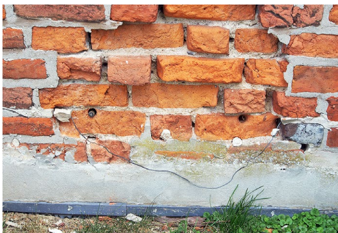
Fot. 8 W gotyckim kościele unikalny przykład dawnego zastosowania metody elektroosmozy z widoczną grzałką i nieczynnym już dziś przewodem, który łączył grzałki
