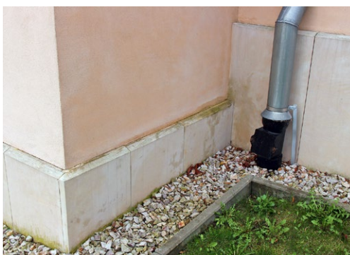
Fot. 1a, b, c, d, e, f, g Przykłady ograniczenia możliwości odpływu wody opadowej wskutek wykonania opaski przyściennej z twardego materiału, z wysokim krawężnikiem blokującym odpływ wody, z brakiem spadku
