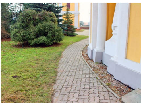
Fot. 2a, b, c Przykłady wykonania izolacji pionowej z odstającej folii kubełkowej, za którą sphywa woda, co skutkuje nawilżaniem, zamiast osuszania
