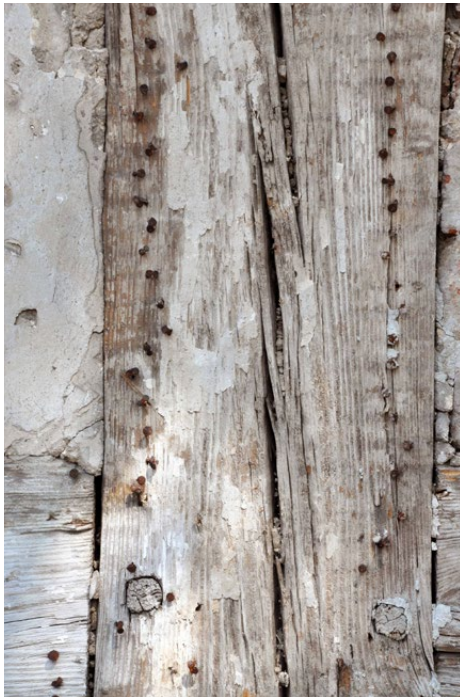
Il. 157 Kutno, pałac podróżny Augusta III z 1750 r. Resztki białej farby na konstrukcji szkieletowej (fot. U. Schaaf, 2017)
