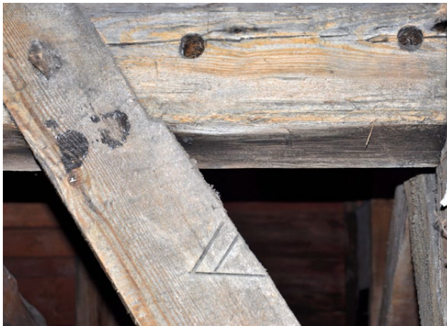
Il. 68 Toruń, kościół pw. św. Janów. Więźba dachowa z lat 30. XV w., ciesielskie znaki montażowe oparte na rzymskim sposobie zapisywania liczb (fot. U. Schaaf, 2018)
