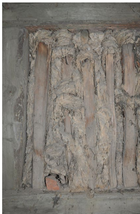
Il. 139 Lubiechnia Mała, kościół Podwyższenia Krzyża Świętego z końca XVII w. Wypełnienia pól w całości z gliny na pionowych żerdziach owiniętych powróżkami ze słomy (fot. U. Schaaf, 2017)
