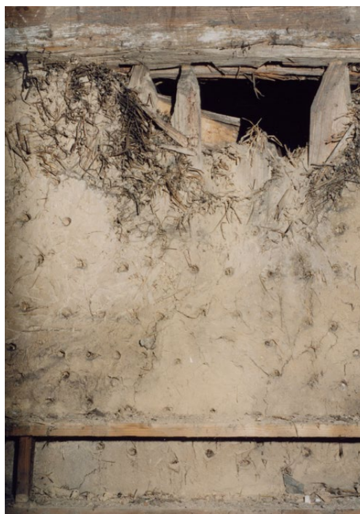
Il. 144 Świdnica, kościół pw. św. Trójcy z 1656–1657 r. Pojedyncze wgłębienia w polach szkieletu wykonane w celu uzyskania lepszej przyczepności tynku (fot. U. Schaaf, 2019)
