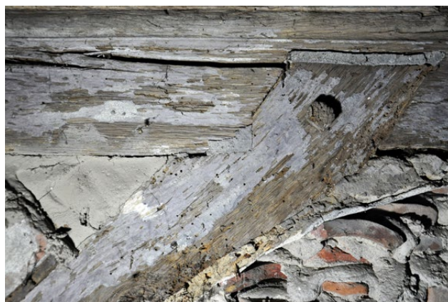
Il. 154 Świerzno, kościół szkieletowy z 1681 r. Wtórnie pomalowane elementy konstrukcyjne na kolor szaro-czarny (fot. U. Schaaf, 2020)
