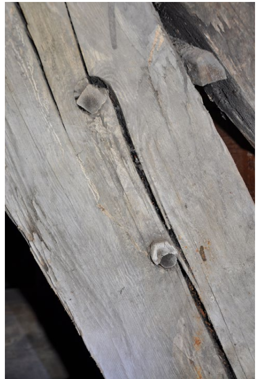
Il. 123 Toruń, kościół pw. św. Janów. Więźba dachowa nad nawą południową z lat 30. XV w. Widoczne dwa kliny ze śrykówką po splewicie w krokwi (fot. U. Schaaf, 2021)
