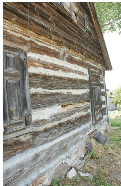
Il. 184 Niedźwiedz, zagroda z końca XVIII w. Elewacja frontowa z widocznym śladem po podciągu oraz połączeniem ściany działowej (fot. M. Prarat, 2008)
