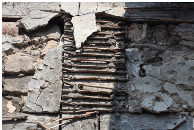
Il. 148 Kutno, pałac podróżny Augusta III z 1750 r. Gwoździe trzymające trzcinę z tynkiem (fot. U. Schaaf, 2017)
