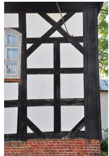
Il. 42 Kalsko, kościół o zdwojonej konstrukcji ścian z 1692–1693 r. Narożne przęsło elewacji. Widoczne zastąpienie dolnych fragmentów konstrukcji i pół szkieletu murem ceglany (fot. U. Schaaf, 2019)
