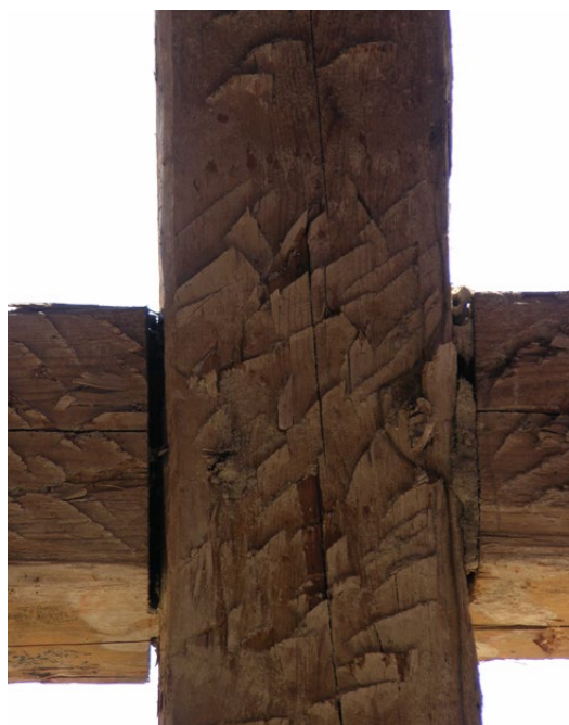
Il. 146 Rościszewice, kościół Podwyższenia Krzyża Świętego z początku XVIII w. Nacięcia na konstrukcji drewnianej wykonane w celu uzyskania lepszej przyczepności tynku (fot. U. Schaaf, 2009)
