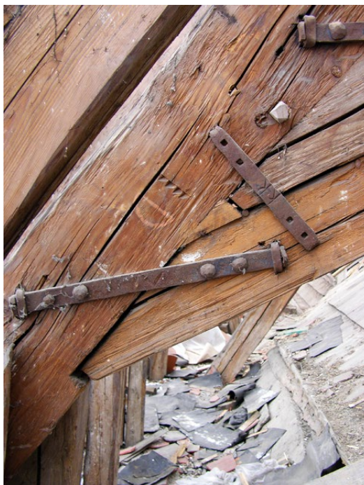
Il. 65 Jelenia Góra-Cieplice, kościół Zbawiciela, 1774–1779 r. Element konstrukcji oznaczony podwójnie – sangwiną i dłutem (fot. U. Schaaf, 2017)
