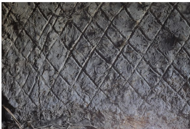
Il. 145 Jasień, kościół pw. Bożego Ciała z 1699 r. Zadrapania w polach szkieletu wykonane w celu uzyskania lepszej przyczepności tynku (fot. U. Schaaf, 2019)
