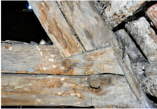
Il. 74 Toruń, kamienica na ul. Mostowej 6. Więźba dachowa z połowy XVI w., znak przechodzący przez jętkę i krokiew (fot. U. Schaaf, 2018)
