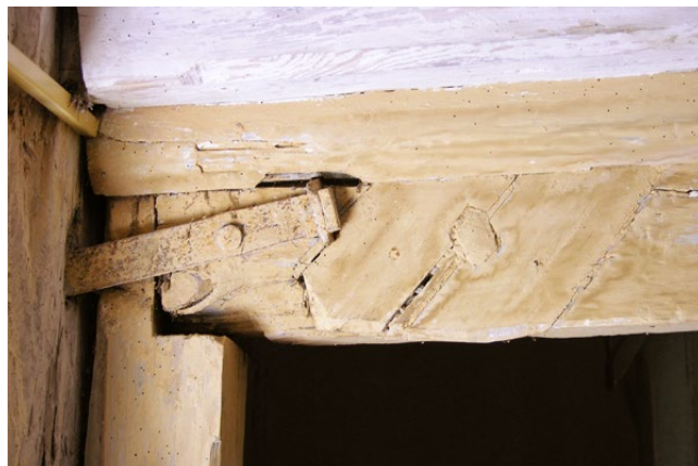
Il. 59 Lubiechnia Mała, kościół Podwyższenia Krzyża Świętego z końca XVII w. Obcięta nakładka zaczepowa w dolnym ryglu obecnej konstrukcji empory (fot. U. Schaaf, 2017)
