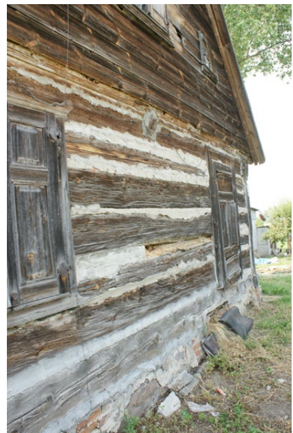
Il. 184 Niedźwiedz, zagroda z końca XVIII w. Elewacja frontowa z widocznym śladem po podciągu oraz połączeniem ściany działowej (fot. M. Prarat, 2008)
