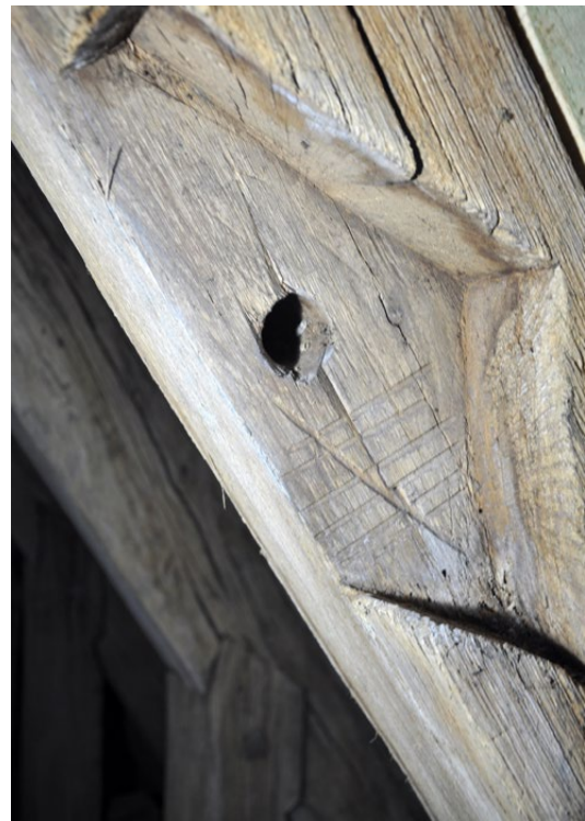
Il. 75 Kamień Pomorski, Konkatedra św. Jana Chrzciciela. Więźba dachowa z połowy XIII w. Ciesielski znak montażowy umieszczony w gnieździe (fot. U. Schaaf, 2020)
