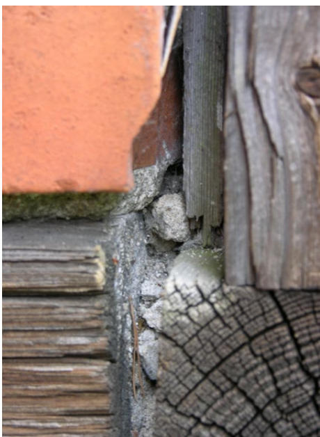
Il. 136 Kasparus, kościół pw. Józefa, 1927 r. Zabezpieczenie wypełnień ceglanych w polach za pomocą trójkątnych listwek przybitych do boków słupów, na które nachodziły cegły z odpowiednio ukształtowanymi wycięciami (fot. U. Schaaf, 2015)
