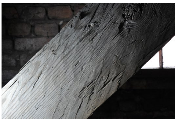
Il. 113 Toruń, kościół pw. NMP. Więżba nad nawą główną, jętkowa o mieszanym systemie konstrukcyjnym. Element obrobiony za pomocą siekiery i topora (fot. U. Schaaf, 2021)
