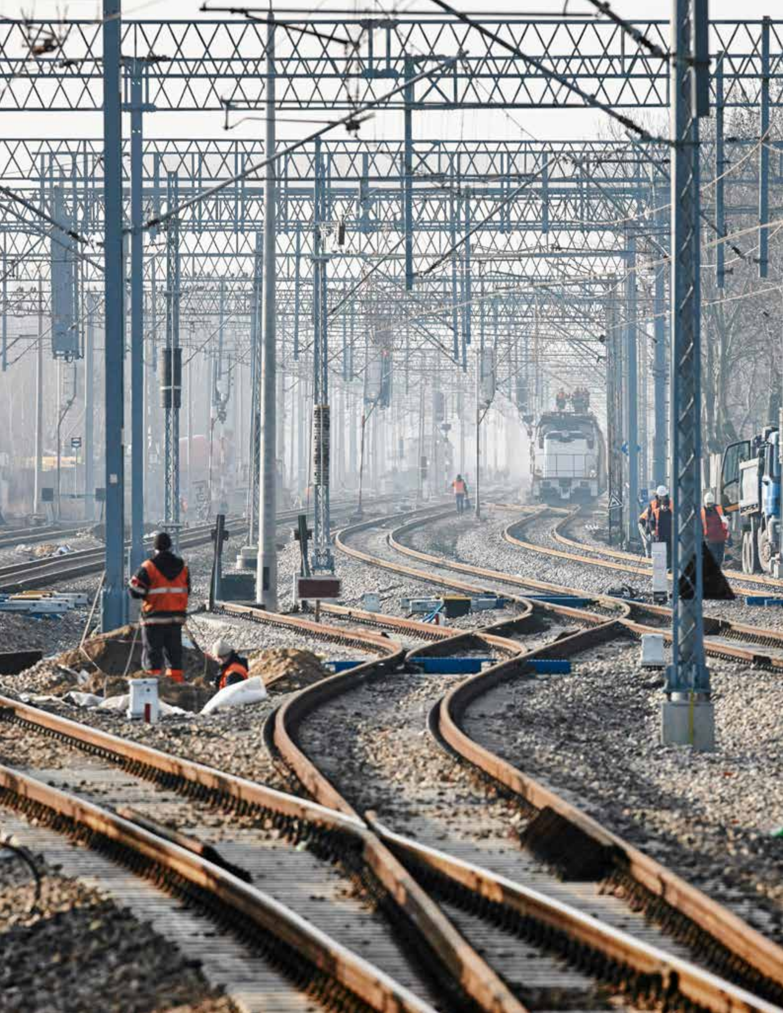
Przebudowa centralnej magistrali kolejowej. Grodzisk Mazowiecki, 2014 r. Fot. Tomasz Stańczak / Agencja Wyborcza.pl
