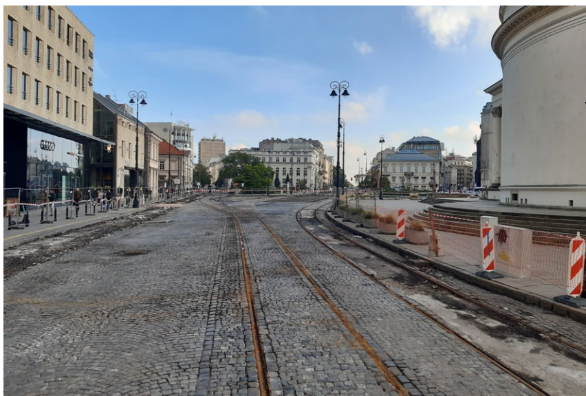
25 Warszawa, plac Trzech Krzyży. Przykład postępowania z nawierzchnią z kostki granitowej odkrytą podczas prac remontowych. Nawierzchnię oczyszczono, zadokumentowano i naprawiono ubytki, a następnie przykryto nakładką asfaltową. Fot. J. Wrzosek, 2023
