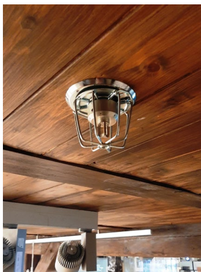
Tryskacz – element stałego urządzenia gaśniczego wodnego. Fot. K. Kociółek
