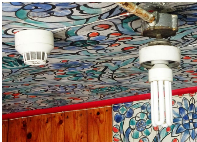
Czy taka instalacja aby na pewno jest bezpieczna? Fot. K. Kociotek
