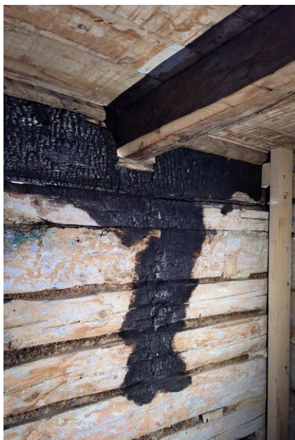
Ślady po rozprzestrzenianiu się ognia po izolacji kabli elektrycznych. Fot. K. Kociołek
