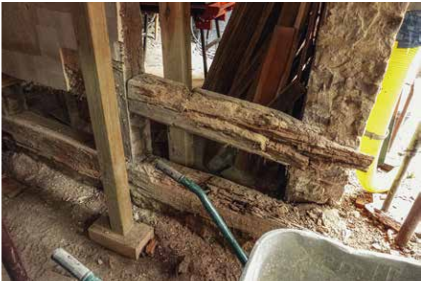
Uszkodzenia drewna w konstrukcji szachulcowej Holzschäden der Fachwerkkonstruktion
