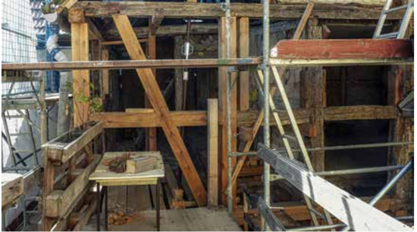
Odrestaurowana szachulcowa konstrukcja od strony dziedzińca Das rekonstruierte Fachwerk auf der Hofseite
