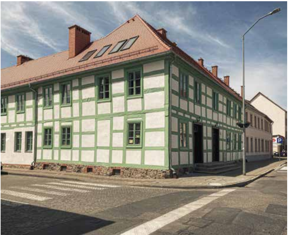
Widok elewacji wschodniej i południowej budynku przy ul. Ratuszowej 11 w Myśliborzu po pracach remontowych, 2023
