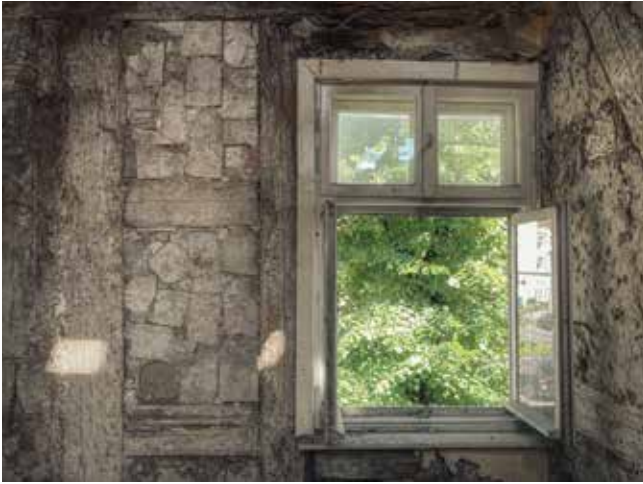
Widok wypełnień pół szkieletu ściany zewnętrznej w budynku przy ul. Rynek 2 w Myśliborzu, 2023
