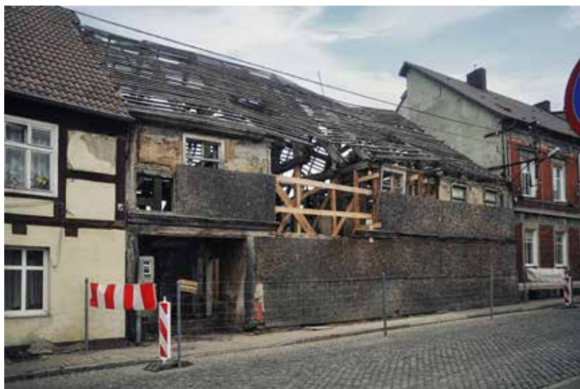
Stan obiektu, fot. T. Cykalewicz, listopad 2018 Zustand: November 2018. Aufn. T. Cykalewicz
