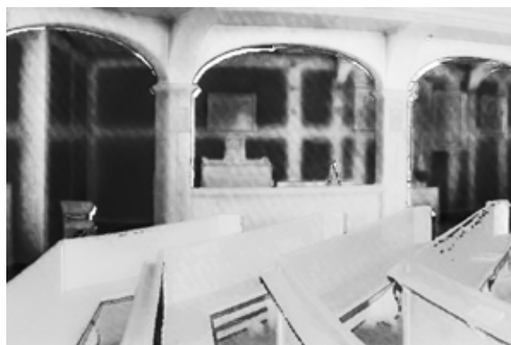
Kościół w Bieczu. Widok na część zachodnią ze zróżnicowaną temperaturą szkieletu ścian uwidocznionych pod tynkiem
