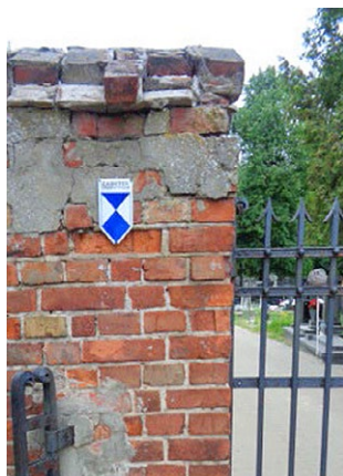
Oznakowanie cmentarza w Słomczynie Błękitną Tarczą („Zabytek chroniony prawem”). Fot. D. Sikora
