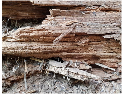
Zniszczenia drewna spowodowane przez grzyby domowe i owady (ksylofagi)
