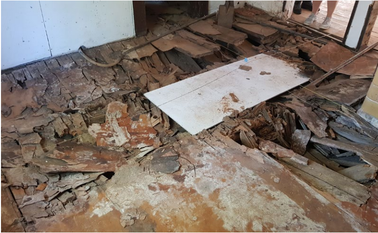
Wnętrze budynku zniszczone przez grzyba domowego – stroczka domowego ( Serpula lacrymans )
