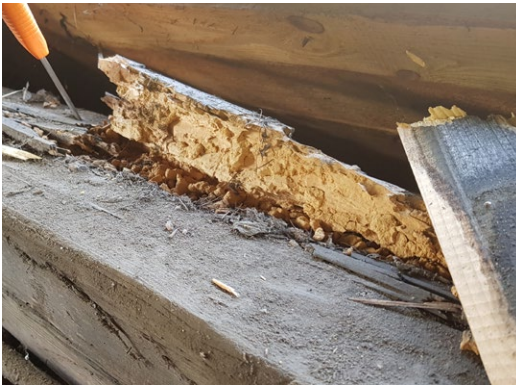
Uszkodzenia elementu drewnianego spowodowane przez larwy technicznych szkodników drewna
