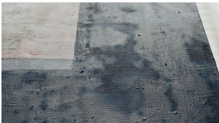
il. 1 Przykład obrazu o dużych nierównościach w potysku powierzchni spowodowanych nierównomierną chłonnością podłoża
