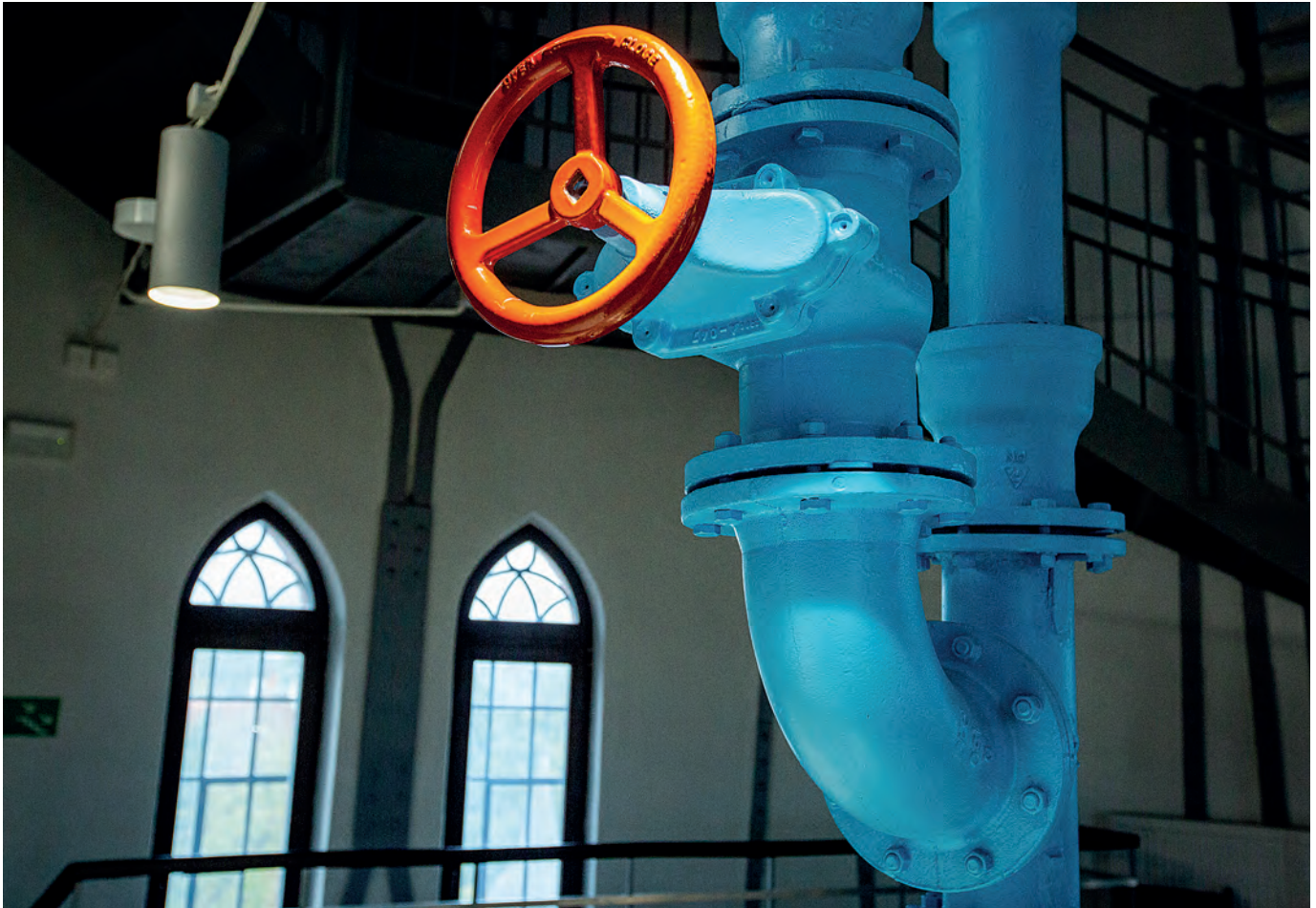
Malbork, wnętrze wieży ciśnieniowej, instalacja
