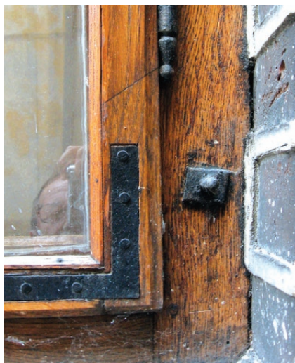
Kraków, Muzeum Książąt Czartoryskich, Klasztor. Końcówka haków do mocowania w murze okien krosnowych zdwojonych. Fot. K. Czepiel, 2016
