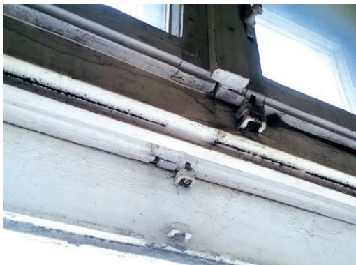
Kraków, kamienica przy ul. Wiślniej 4. Zaczepek prętów zasuwnicy na ślemieniu. Fot. K. Czepiel, 2016
