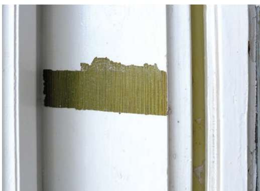
Wieliczka, zabytkowy dworzec kolejowy. Spod łuszczącej się warstwy odstronione pierwotne modernistyczne słojuwanie w kolorze zielonym. Fot. B. Gostyńska, 2016
