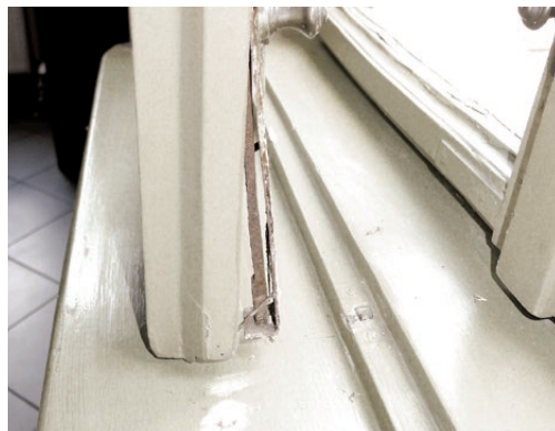
Kraków, ul. Westerplatte, pałac Pusłowskich. Uszkodzona zasuwka w oknie z lat 80. XIX wieku. Fot. K. Czepiel, 2018
