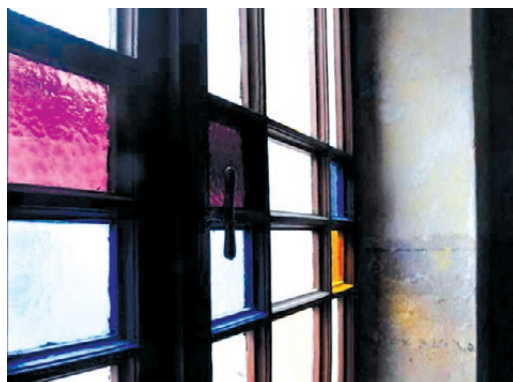
Kraków, kamienica przy ul. Skłodowskiej-Curie 7. Charakterystyczny sposób szklenia barwnymi wylewanymi szybami okien na klatkach schodowych na przełomie XIX i XX wieku. Fot. K. Czepiel, 2008
