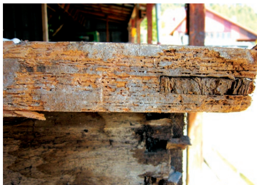
Kraków, budynek szkoły przy ul. św. Marka 34 z 2. połowy XIX wieku. Ościeżnica okna zaatakowana przez owady. Fot. K. Czepiel, 2011
