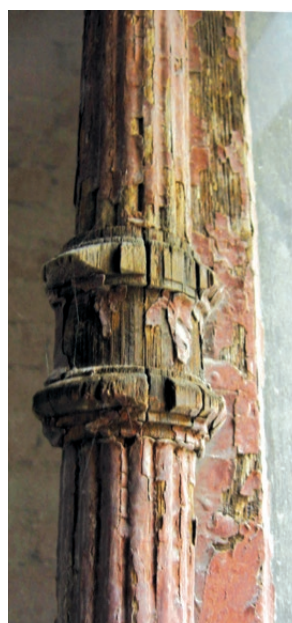
Kraków, kamienica przy ul. Garbarskiej 6, okno z roku 1896. Listwa przyrywkowa wypłukana przez deszcz i słońce. Fot. K. Czepiel, 2019
