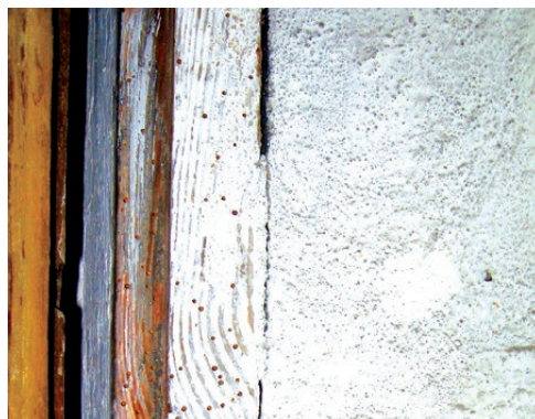
Kraków-Bielany, klasztor Kamedułów. Krosno okna babińca z 2. połowy XIX wieku zaatakowane przez owady. Fot. K. Czepiel, 2014
