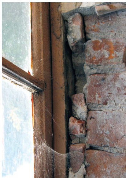
Okno jednoramowe na klatce schodowej, otwierane na zewnątrz, zawieszone na murze elewacji za pomocą haków, bez uszczelnień – zbliżenie detalu. Fot. K. Czepiel
