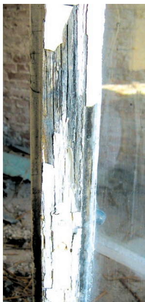
Kraków, kamienica przy ul. św. Marka 37, okno z okresu II wojny światowej. Powierzchnia ramiaka skrzydła zewnętrznego zniszczona przez czynniki atmosferyczne. Fot. K. Czepiel, 2019
