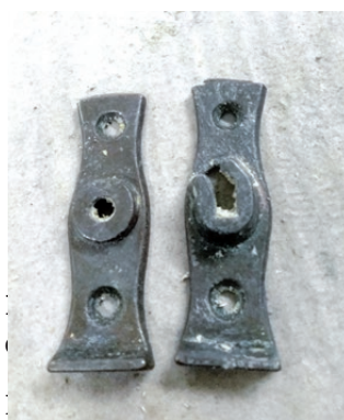
Kraków, budynek Akademii Sztuk Pięknych przy ul. Smoleńsk 9. Łożysko rolety przeciwsłonecznej. Fot. K. Czepiel, 2019
