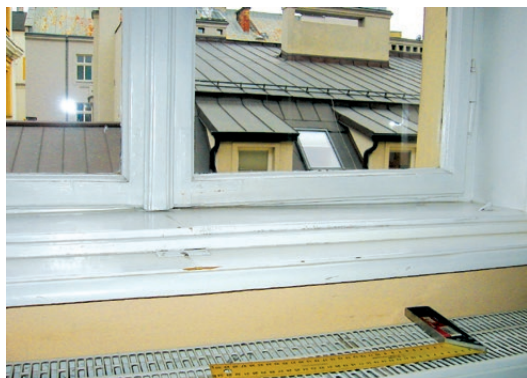
Kraków, budynek Starego Teatru. Wybrzuszenie progu ościeżnicy w oknie skrzynkowym. Fot. K. Czepiel, 2016
