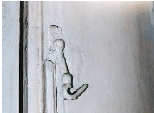
Kraków, budynek szkoły przy ul. Szujskiego 2. Hak przeciwwiatrowy w oknie z połowy XIX wieku. Fot. K. Czepiel, 2006
