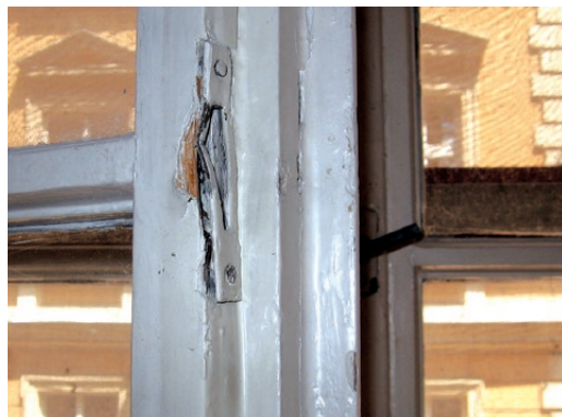
Kraków, kamienica przy ul. św. Marka 37. Blacha czołowa w lewym skrzydle okiennym. Fot. K. Czepiel, 2020
