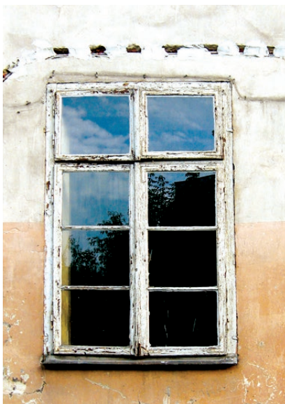
Okno jednoramowe otwierane na zewnątrz, zawieszone na murze elewacji za pomocą haków. Proszę zwrócić uwagę na wylewane szyby. Fot. K. Czepiel
