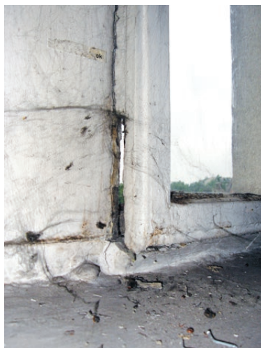
Kraków, al. Mickiewicza 5, budynek szkoły. Stan okien przed konserwacją. Fot. K. Czepiel, 2009
