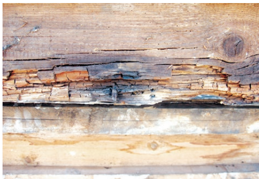
Kraków, budynek szkoły przy ul. św. Marka 34 z 2. połowy XIX wieku. Ościeżnica okna zaatakowana przez zgniliznę 27 . Fot. K. Czepiel, 2011
