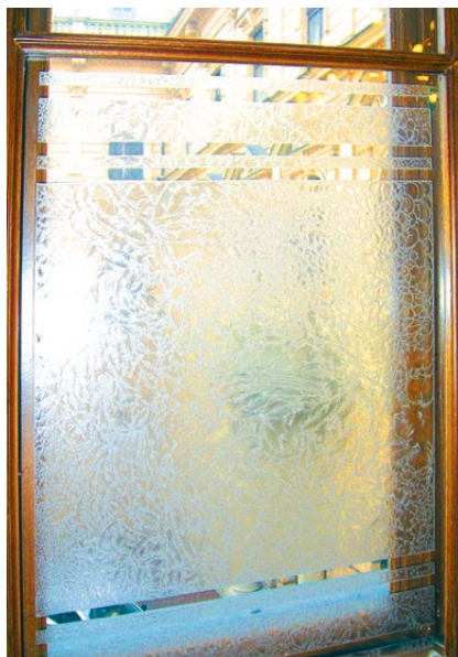
Kraków, budynek banku przy ul. Szpitalnej 15. Szyby mrożone 31 w oknie skrzynkowym. Fot. K. Czepiel, 2010
