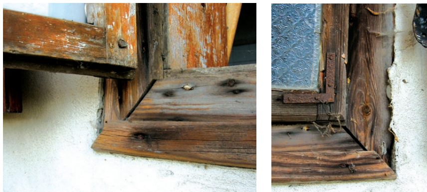
Goszyce, dwór drewniany z wieku XVII, okno z wieku XIX. W drewnianych dworach i chałupach okna ościeżnicowe montowane były do opasek zewnętrznych, a nie do ościeżnicy. Fot. K. Czepiel, 2017
