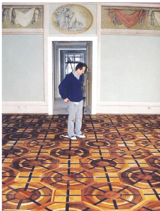
Kraków, kamienica Szołajskich (obecnie oddział Muzeum Narodowego). Parkiet taflowy po zabezpieczeniu przez autora tego tekstu powierzchnią pokostem i woskiem z kalafonią. Fot. M. Kęsek, 2002
