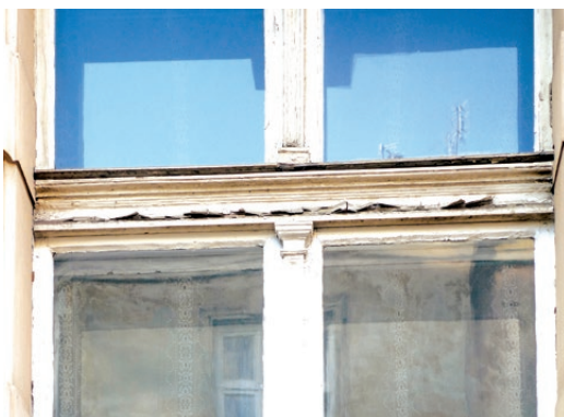
Kraków, okno z roku 1895 w kamienicy przy ul. Westerplatte. Łuszczące się powłoki olejne na śleminiu. Fot. K. Czepiel, 2022
