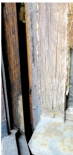
Kraków, kamienica przy ul. Brackiej 4, okno dębowe z lat 70. XX wieku. Powierzchnia wyplukana przez deszcz i słońce. Fot. K. Czepiel, 2018
