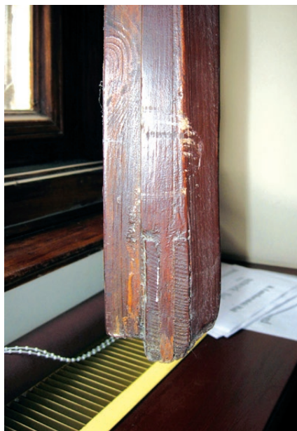
Kraków, budynek Polskiej Akademii Umiejętności przy ul. Sławkowskiej 17. Na zdjęciu widać ramiak skrzydła rozcięty wzdłuż. Do oryginalnego elementu profilowanego doklejono dwie warstwy nowego drewna i wyrobiono potrzebne wręby i przymyki. Rozwiązanie zastosowane (skutecznie) w niektórych oknach w czasie ostatniej konserwacji w roku 1997. Fot. K. Czepiel, 2017
