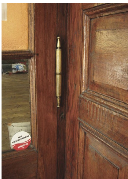
Pleszów, dawny pałac Kirchmayerów z 1. połowy XIX wieku. Bejcowane na kolor dębu drzwi wewnętrzne i szpalety. Fot. K. Czepiel, 2016
