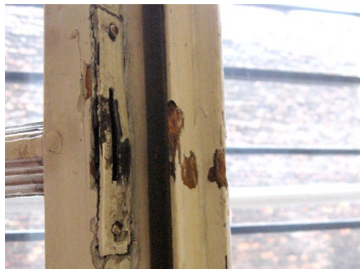
Kraków, budynek banku przy ul. Pijarskiej 1. Blacha czołowa w lewym skrzydle okiennym. Fot. K. Czepiel, 2013
