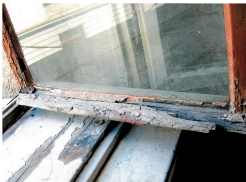
Kraków, kamienica przy ul. Garbarskiej 6. Dolny ramiak skrzydła uszkodzony przez wilgoć. Fot. K. Czepiel, 2019
